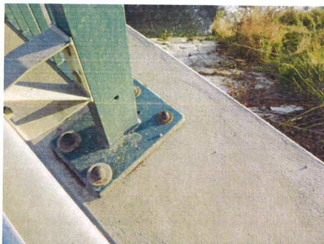
koroze kotevnic prvku
