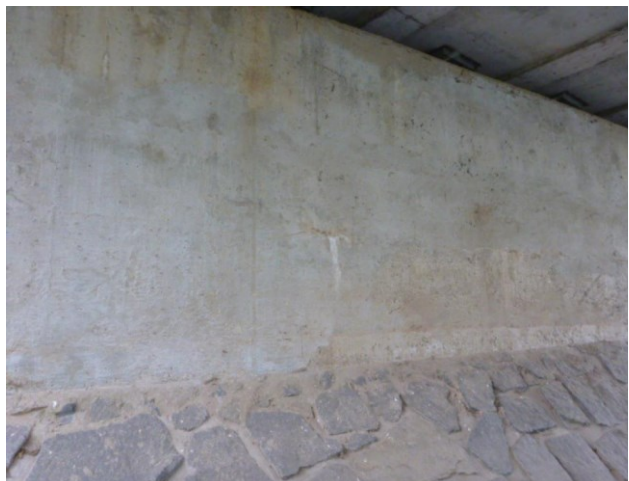
Lokální průsak opěrou na konci vlevo
