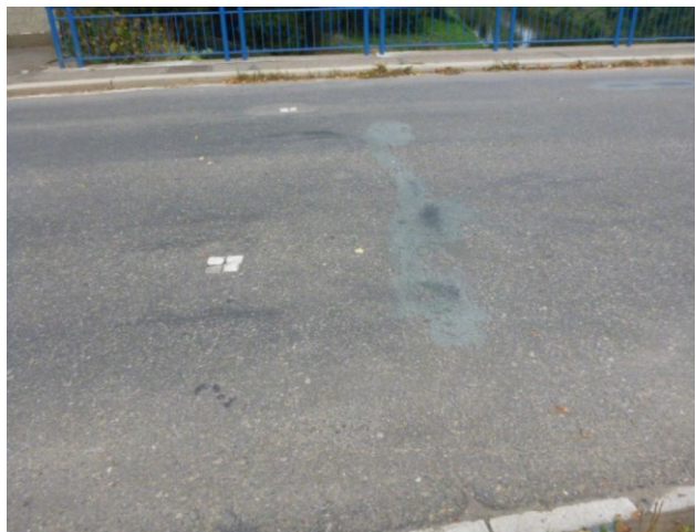
Poruchy krytu nad opěrou na začátku mostu
