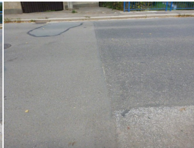
Otevřená spára na začátku mostu
