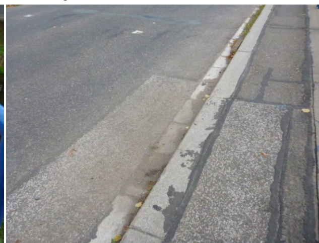
Mírně propadlá vozovka na začátku mostu vpravo
