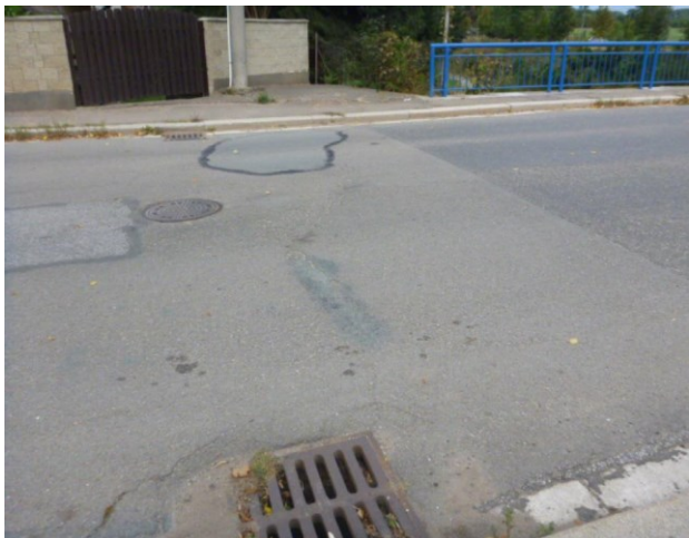
Poruchy krytu před mostem
