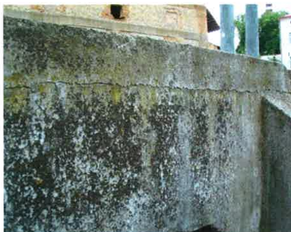
vodorovná trhлина v místě nadbetonování římsy
