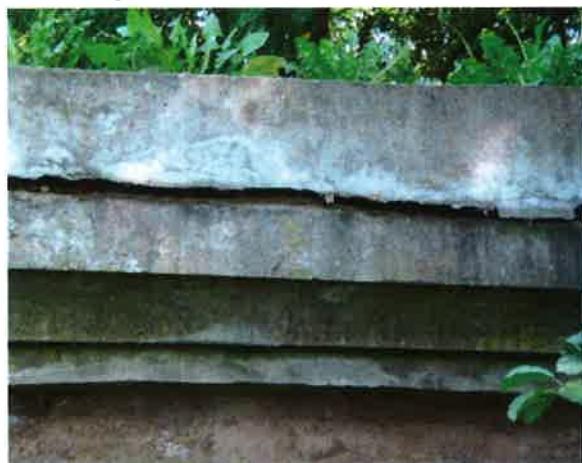
popraskaný beton římsy vpravo
