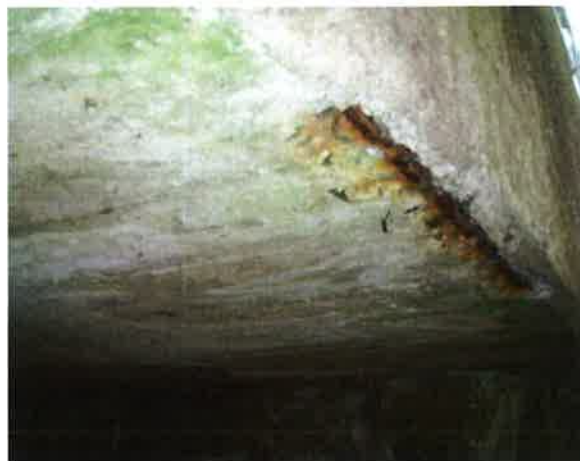
obnažená zkorodovaná výztuž na hraně NK vpravo
