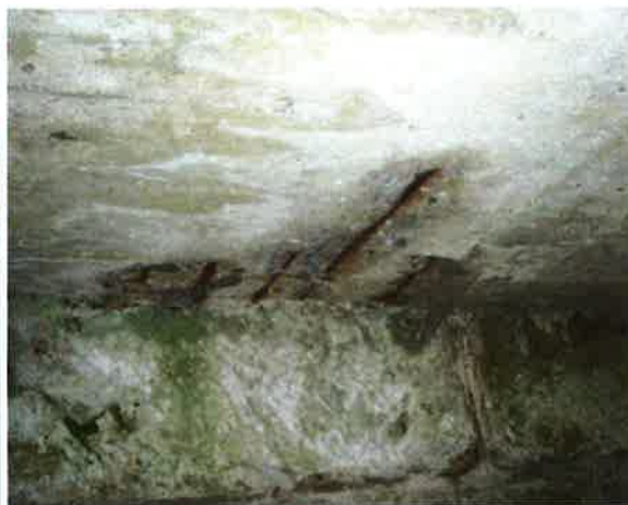
obnažená zkorodovaná výztuž na podhledu NK
