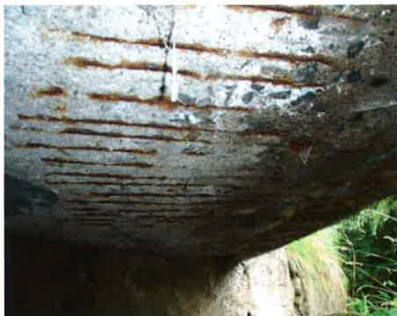
obnažená zkorodovaná výztuž na pohledu NK
