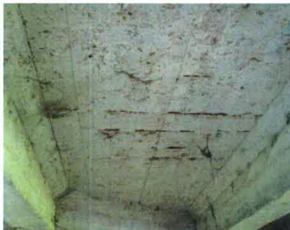
lokálně proeýsovaná korodující výztuž na podhledu BR
