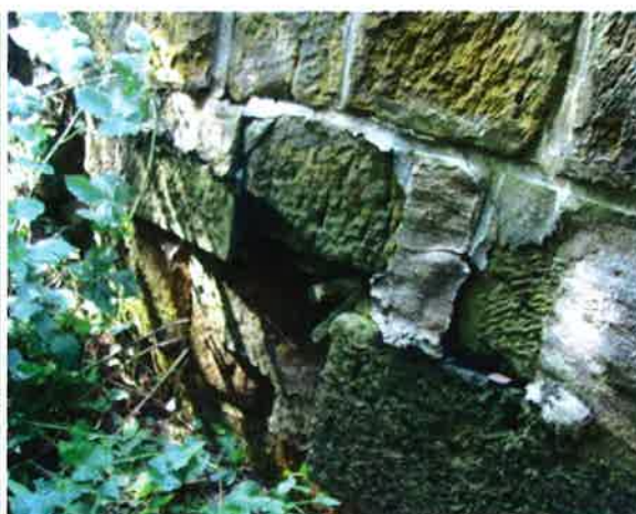
vypadlý kvádr křídla na začátku mostu vpravo
