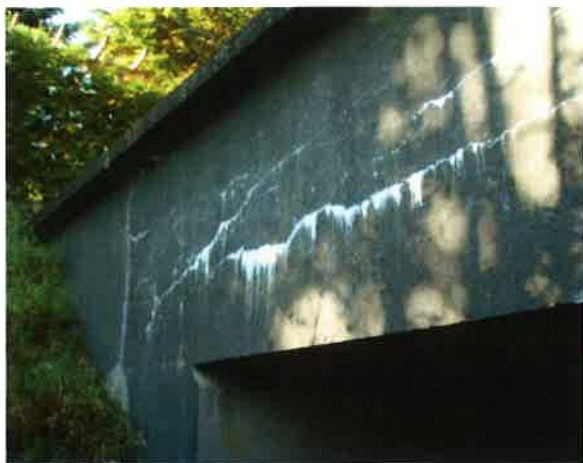
vodorovně protékající trhliny v parapetní zídce NK po levé straně mostu
