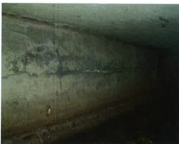
vodorovná zvodnělá trhлина v opěře na konci mostu
