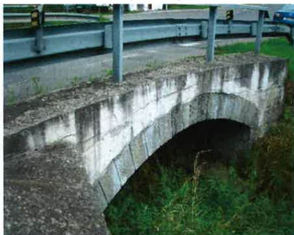
podélné trhlinky na boku římsy vpravo
