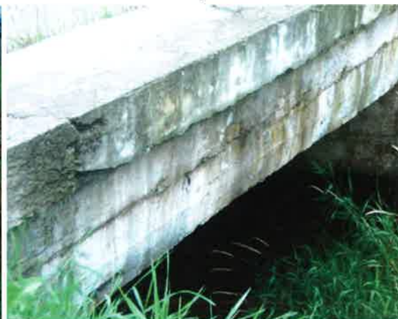
degradovaný beton římsy vlevo
