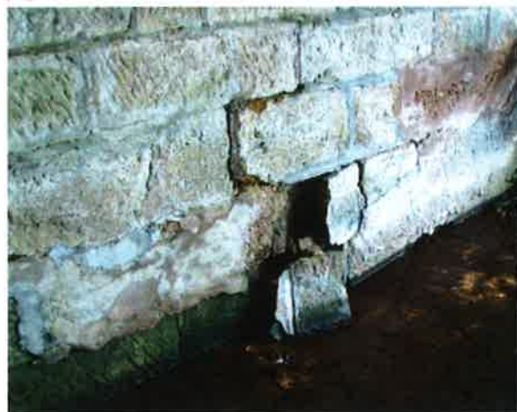
vypadlé kvádry opěry na konci mostu
