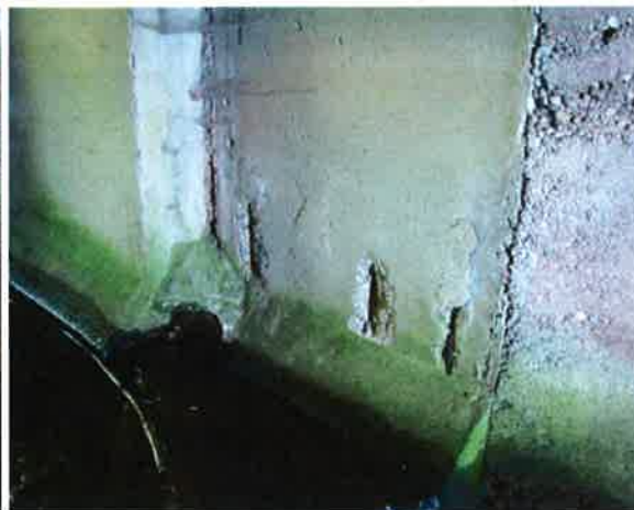
obnažená výztuž na stěně BR
