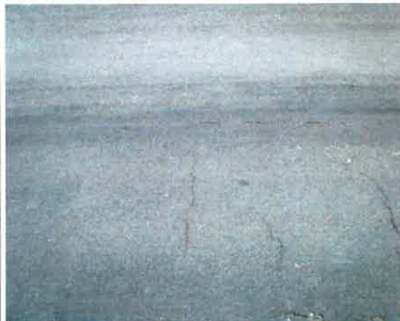
trhliny v živичném krytu vozovky
