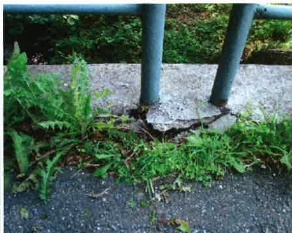
porušený beton římsy
