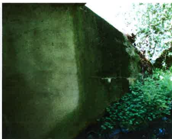
podélná trhлина a uchycený mech na křídle na začátku mostu vlevo
