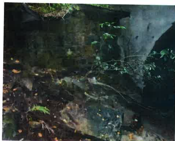
poškozené kamenné zpevnění křídla na zač.mostu pravo
