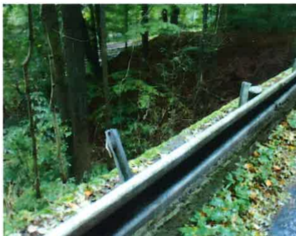
poškozený reflexní patník
