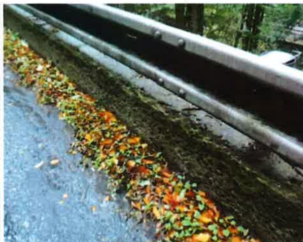
hloubkově degradovaný beton řimsy vpravo
