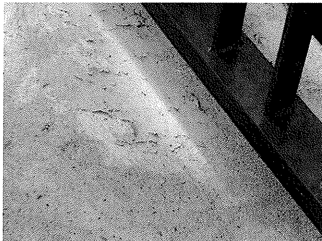
loupající se ochranný nátěr chodníku
