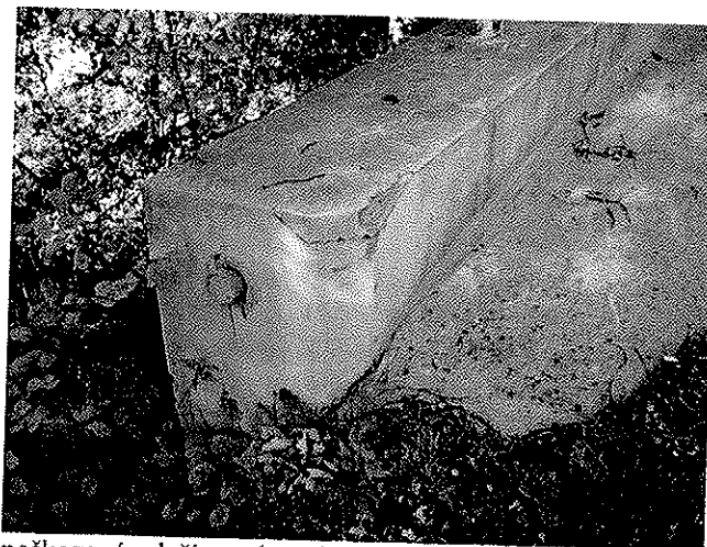
poškozený roh římsy (nové) na začátku mostu vlevo
