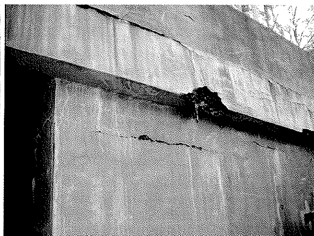
vodorovné prsskliny v křídle na konci mostu vpravo a rozpadlý beton pův.římsy
