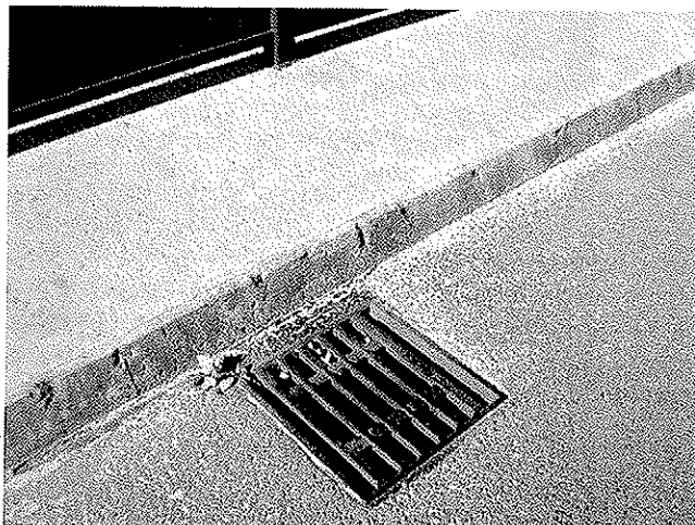
porušený beton s obnaženou a zkorodovanou výztuží obrubníku
