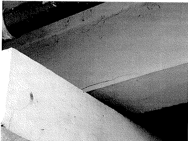
podélná trhlina při spodní hraně trámu na konci mostu vlevo
