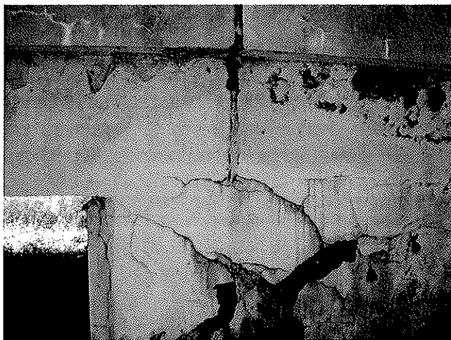
detail poškozené omítky ( a částečně i betonu) rohu opěry a křídla na konci mostu vpravo
