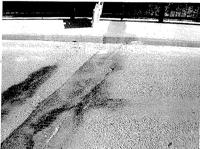
trhlina a lokální výtluk v místě dilatačního závěru na konci mostu vpravo
