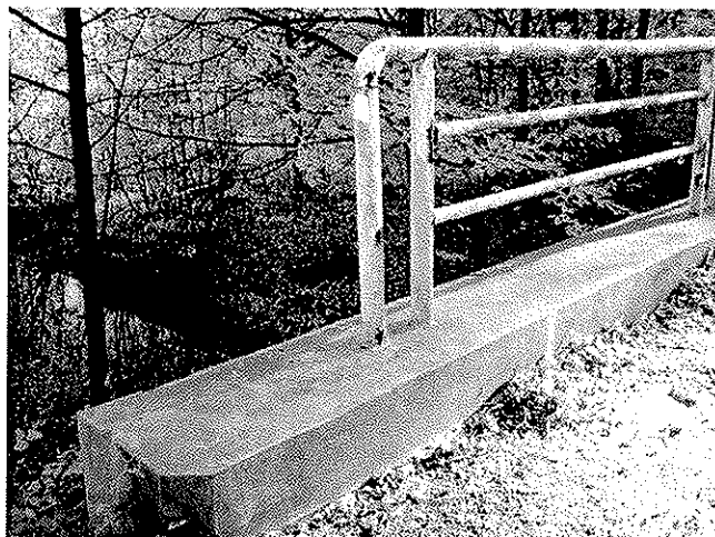
mírně zkorodované zábrsdlí
