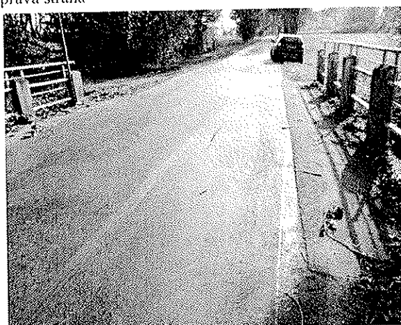
poruchy krytu vpravo
