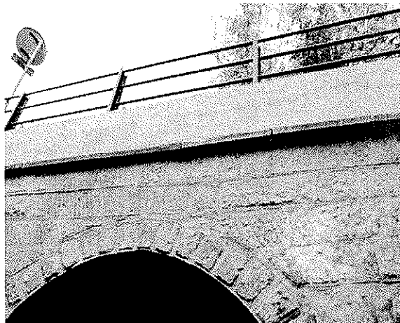
trhliny v římse vpravo
