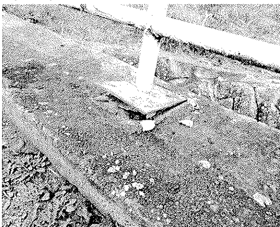
vyvrácené zábradlí vlevo
