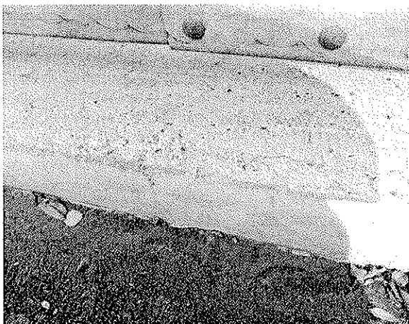
poruchy betonu římsy vlevo
