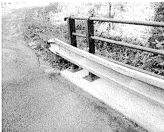
poškozené svodidlo na začátku vlevo
