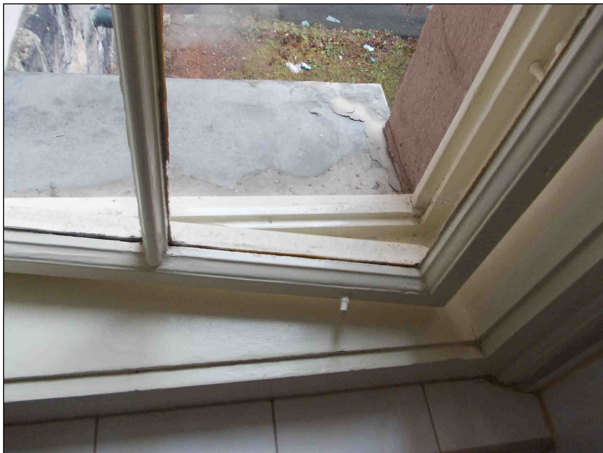
JEDNOKŘÍDLOVÉ OKNO (Č. 146) - SKUPINA 1 - TĚMĚŘ NEPOŠKOZENÉ OKNO
