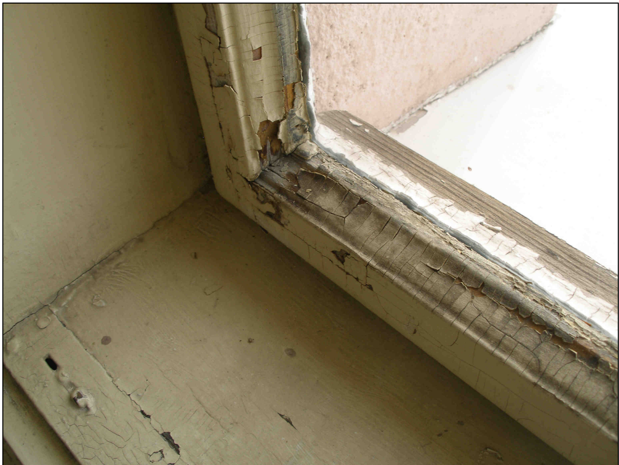
DVOUKŘÍDLOVÉ OKNO (Č. 235) - SKUPINA 3 - POŠKOZENÍ VNĚJŠÍCH RÁMŮ, NEFUNKČNÍ KOVÁNÍ
