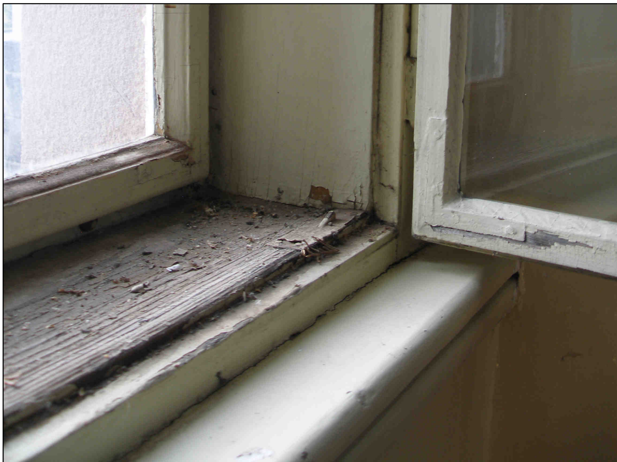
ŠESTIKŘÍDLOVÉ OKNO (Č. 103) - SKUPINA 4 - POŠKOZENÍ VNĚJŠÍCH I VNITŘNÍCH RÁMŮ A ŠPALET, NEFUNKČNÍ KOVÁNÍ
