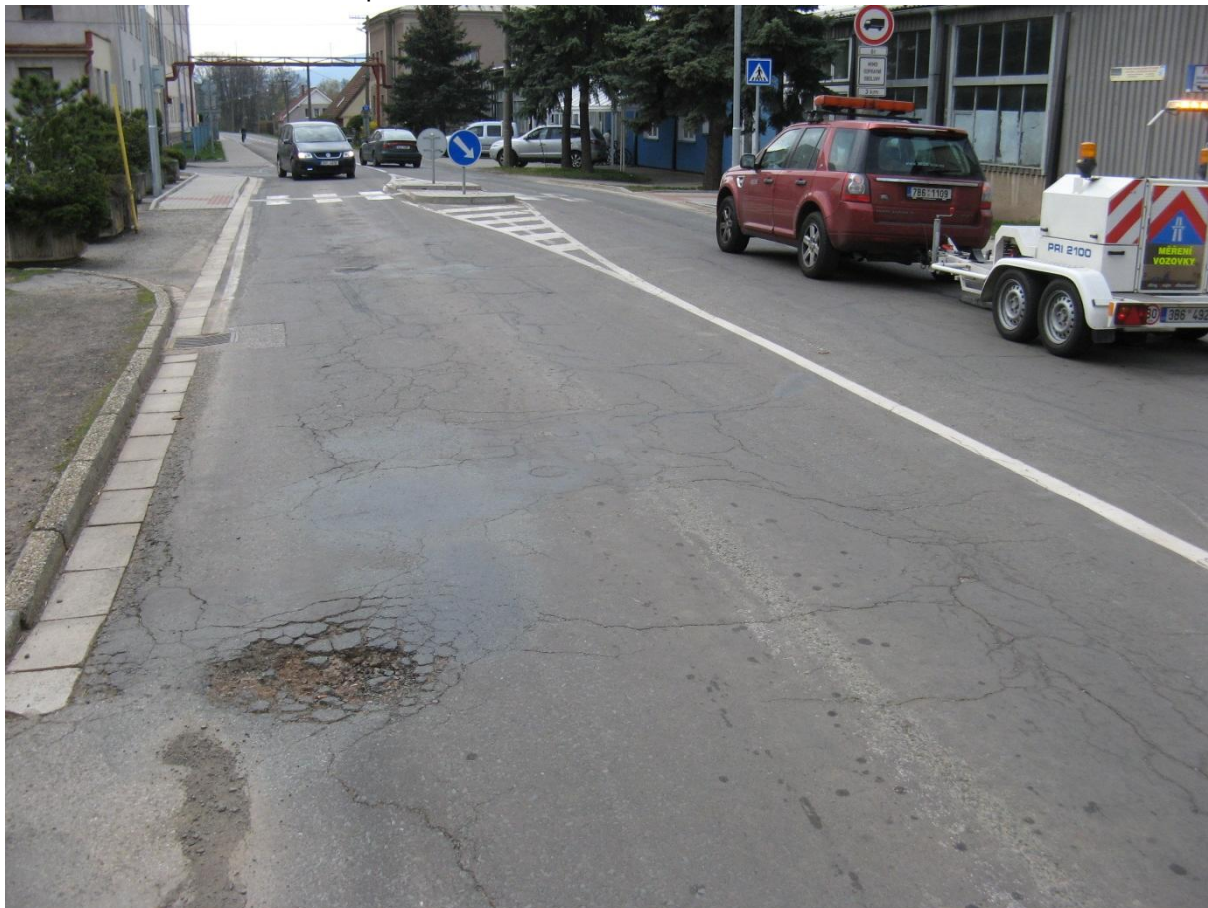
F03, km 11,640+ Výtluk a celoplošné nepravidelné nebo mozaikové trhliny.
