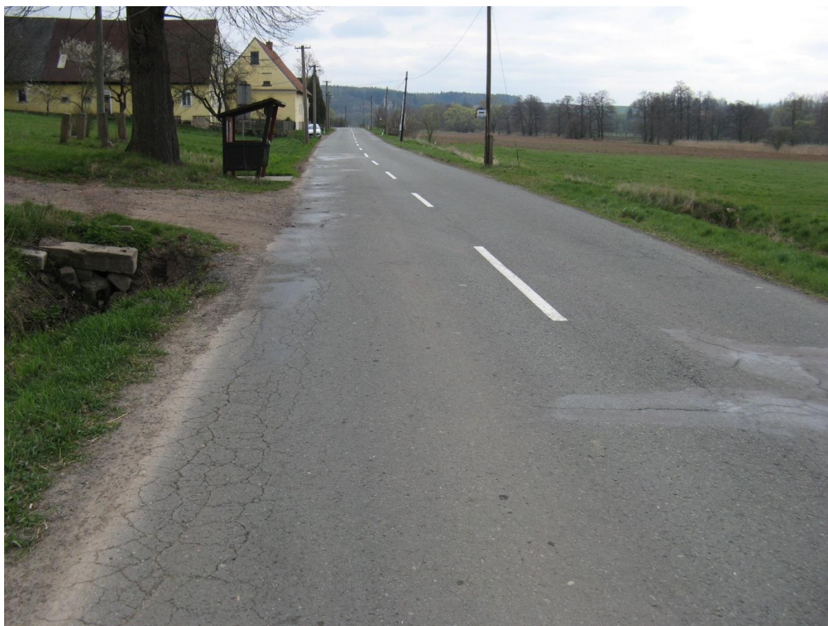
F34, km 13,110+ Síťové trhliny podél okraje vozovky.
