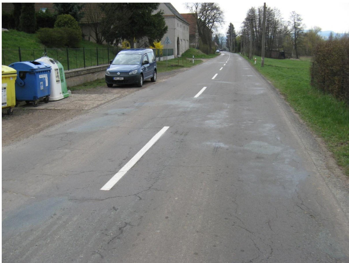
F09, km 11,860+ Celoplošné nepravidelné nebo mozaikové trhliny ošetřované tryskovou metodou..
