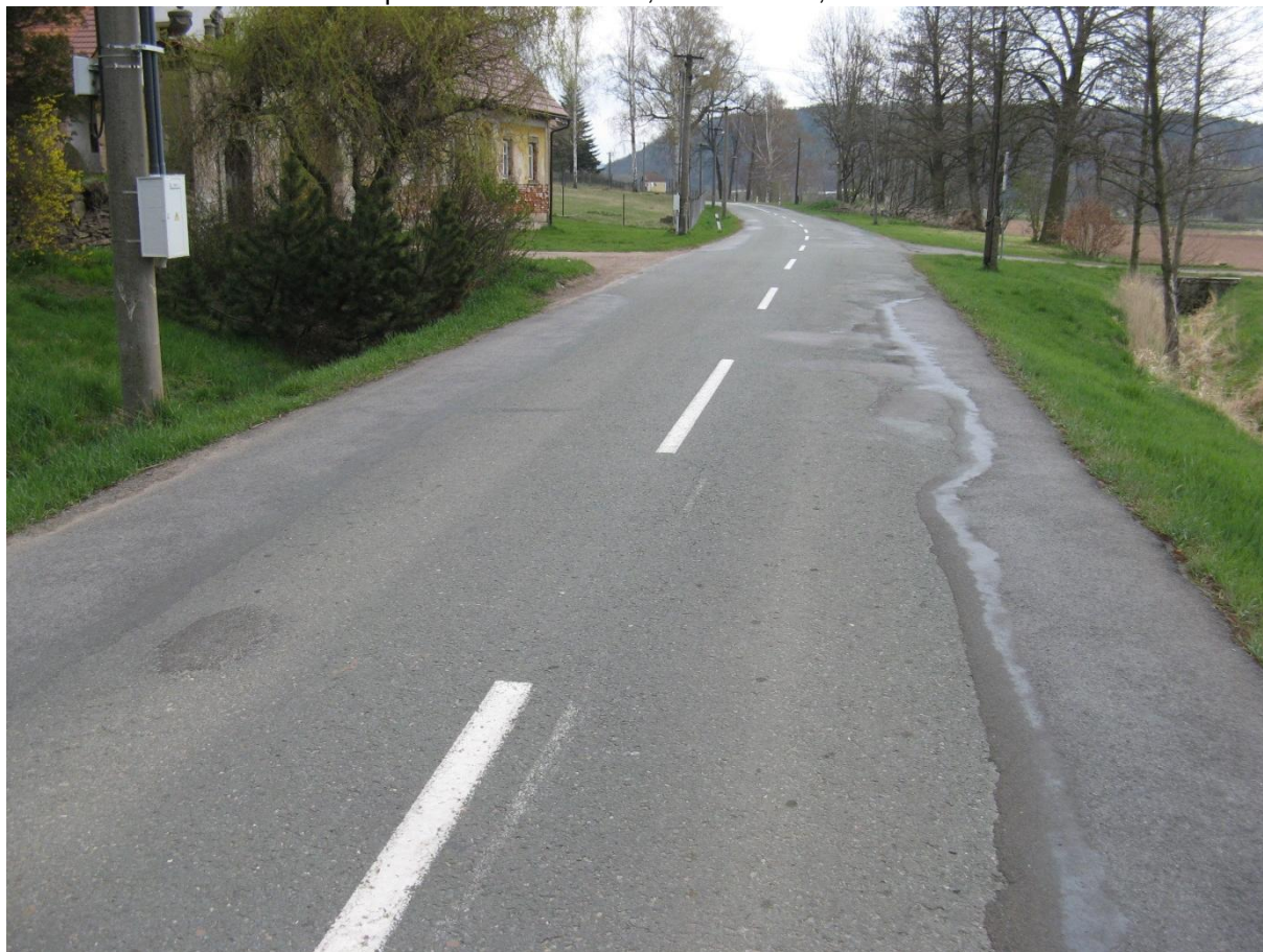
F49, km 13,810+ Vysprávky podél obou okrajů vozovky.
