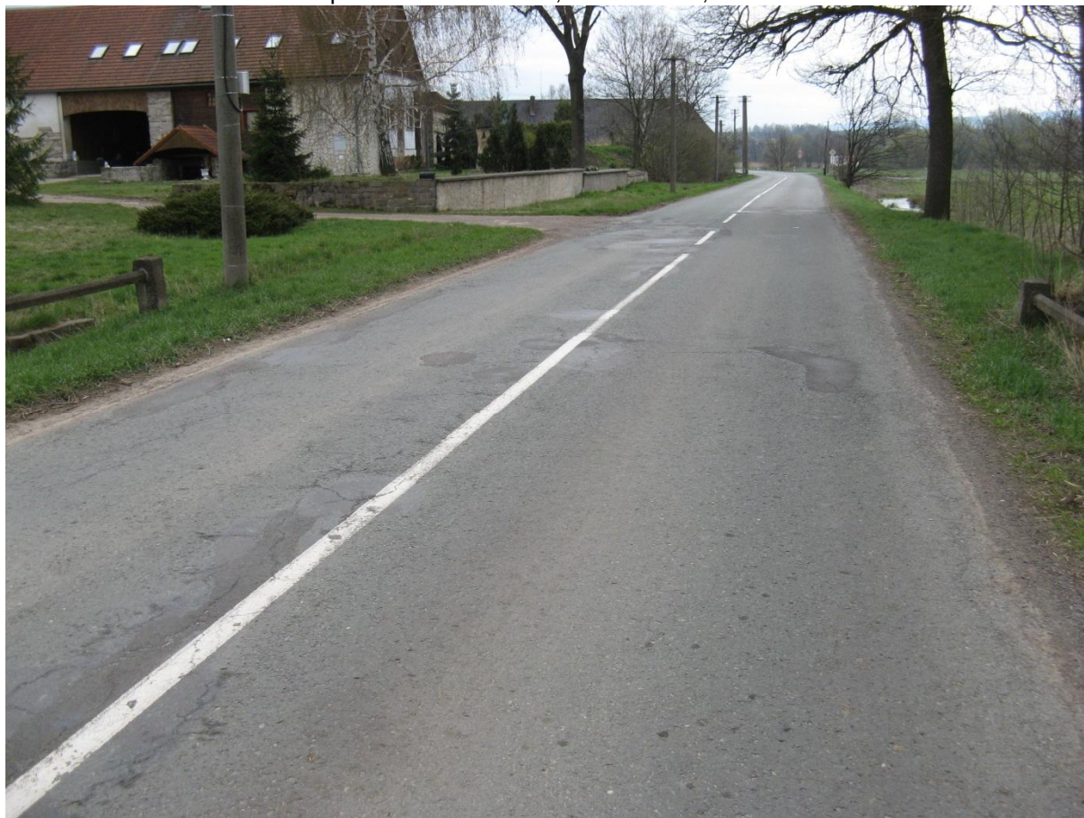
F26, km 12,710+ Mozaikové trhliny a vysprávkky.
