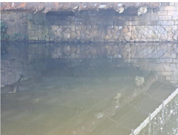
OP1_lokálně vypadané spáry zdiva
