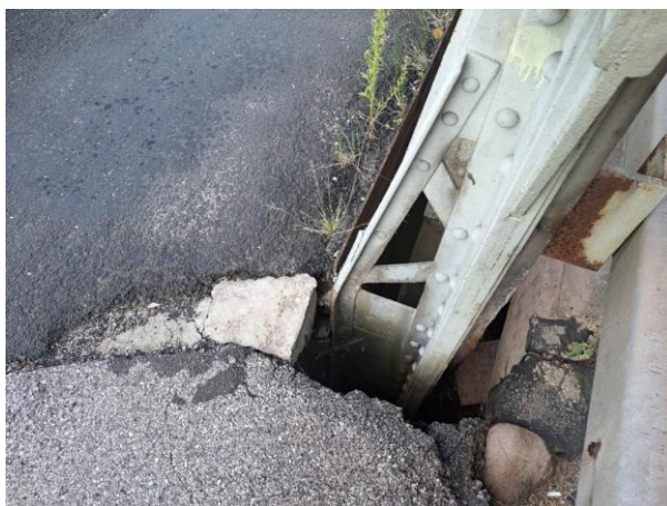
lávka _začátek mostu vlevo_ nezabezpečené místo_u hlavního nosníku
