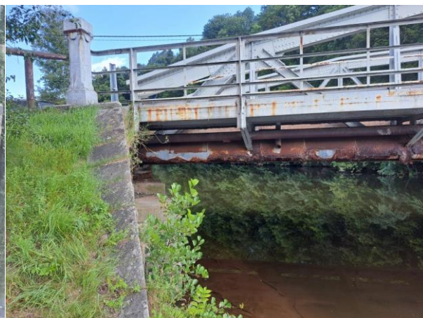
křídlo OP2_vlevo zakořeněná vegetace
