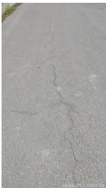
Trhliny v levé části vozovky na mostě
