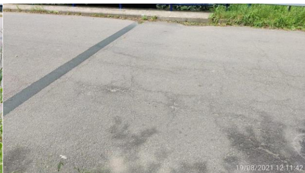
Kleslý kryt vozovky na předpolí mostu
