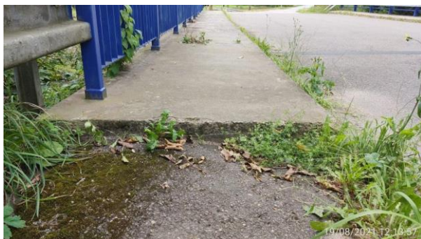
Kleslý kryt chodníku na konci mostu vpravo
