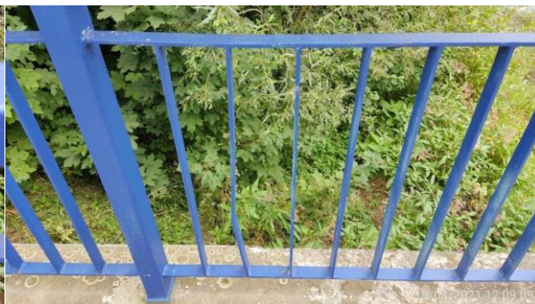
Lokálně poškozené pravé zábradlí
