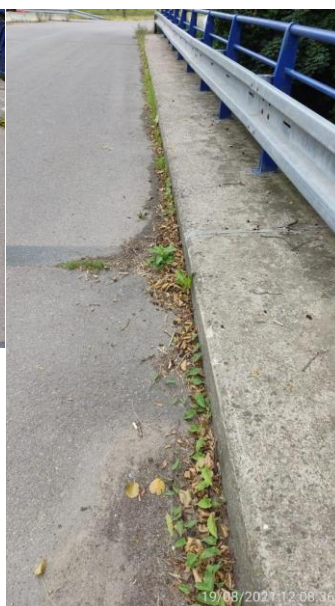
Horní plocha levé římsy a vegetace na krajnici
