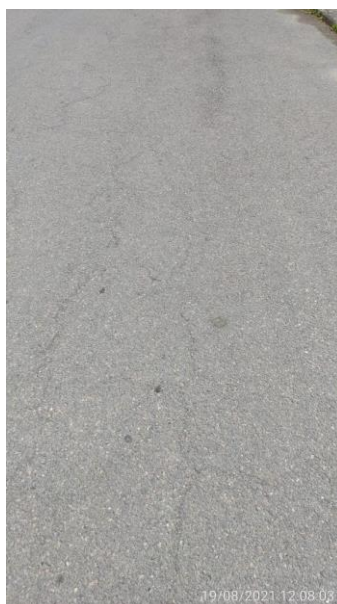
Trhliny v pravé části vozovky na mostě
