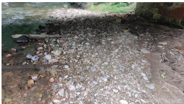
Nános naplavenin u opěry OP2
