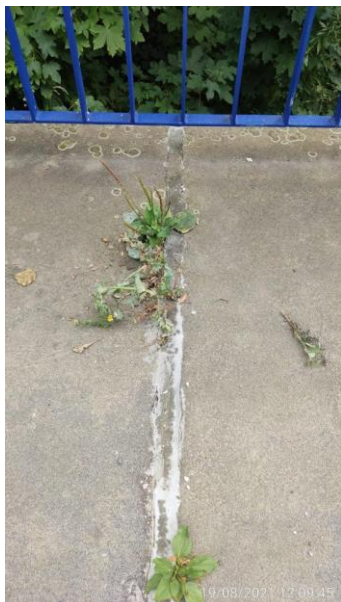
Netěsný tmel v dilataci chodníku
