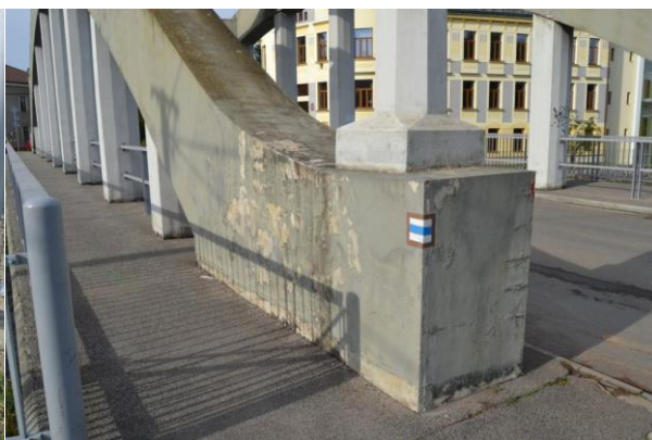
-Odloupaný nátěr konstrukce v místech stékání vody
