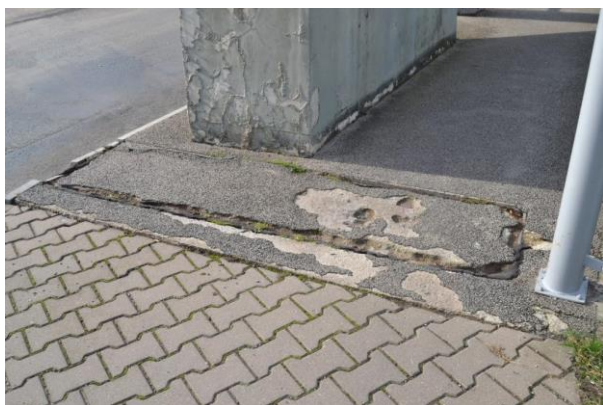
-Rozpad závěru chodníku na konci mostu vlevo
