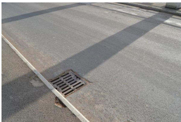
-Odvodňovač na mostě
