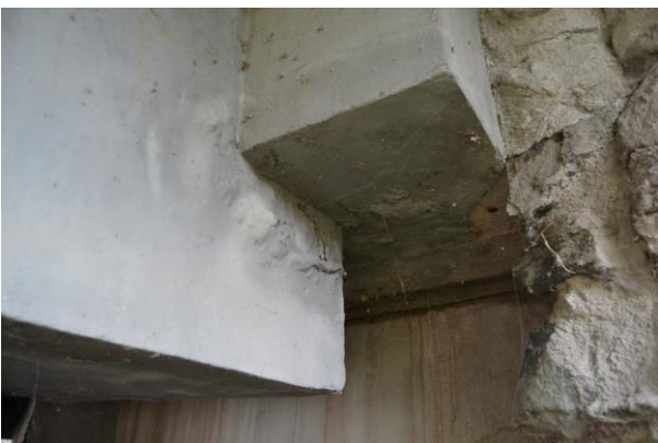
-Zavlhhlý konec mostu, degradace betonu
