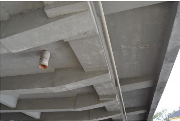
-Podhled NK-trhlina a výluhy v konzole
