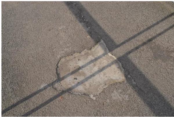
-Vady ve stříkané pochozí izolaci chodníku
