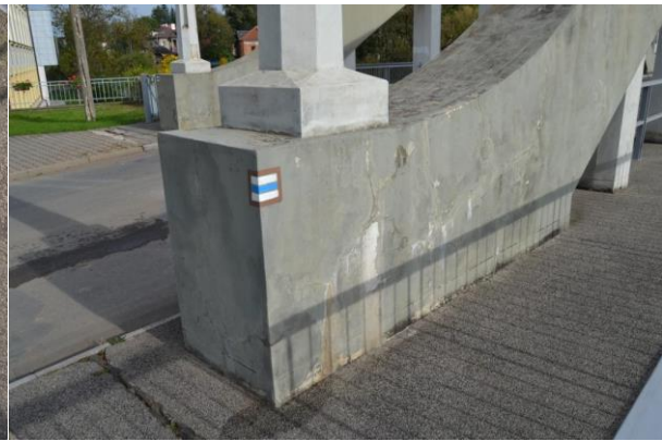
-Trhliny s výluhy na NK
