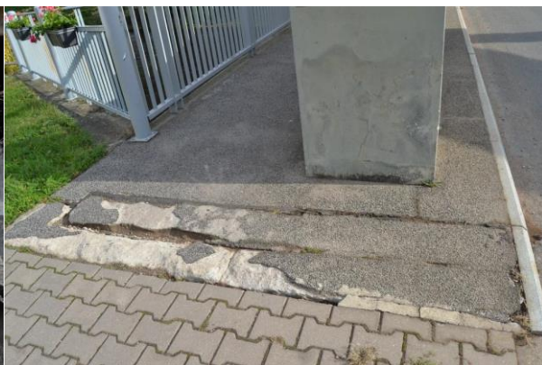
-Rozpad závěru chodníku na začátku mostu
