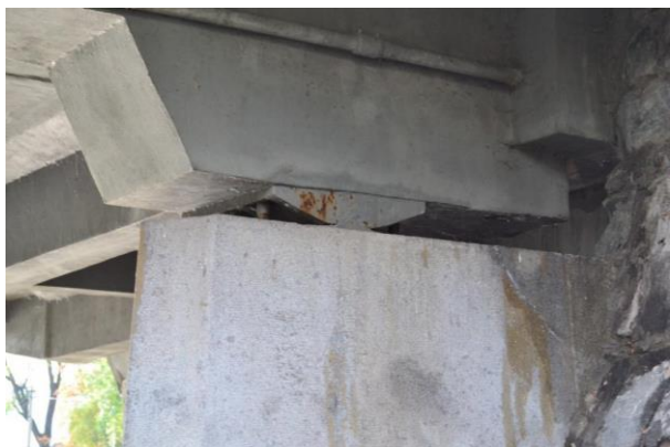
-Pevné uložení OPl, zatékání na úložný práh
