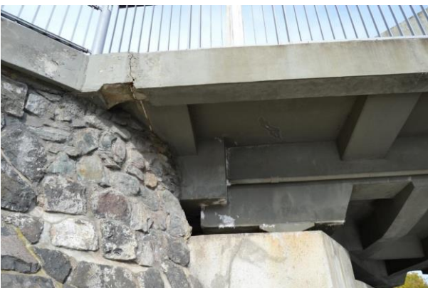
-Zatékání na začátku mostu, trhlina s výluhy na konzole
