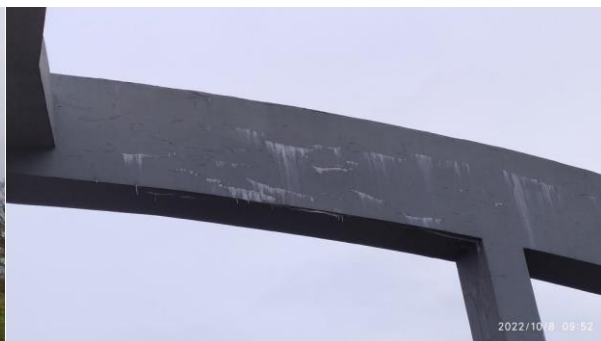
Trhliny s výluhy na oblouku vlevo
