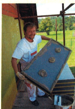
Nanášení lepicí hmoty se provádí ve formě obvodového věnce a tří bodů uprostřed desky
