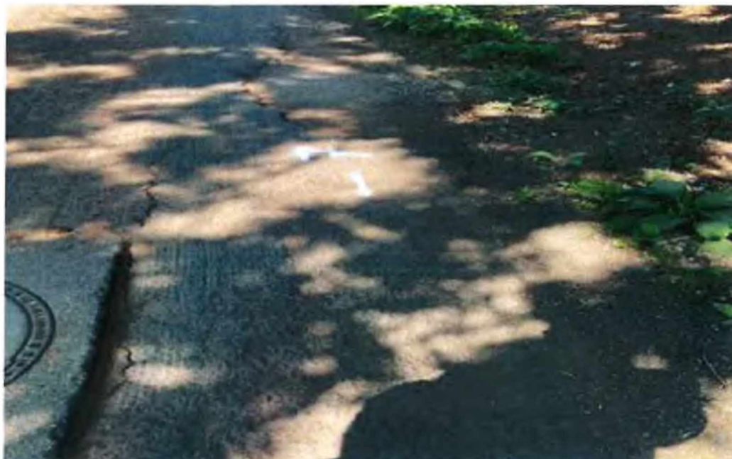
Úsek č.3- podélná trhlina na rozhraní rýhy kanalizace
