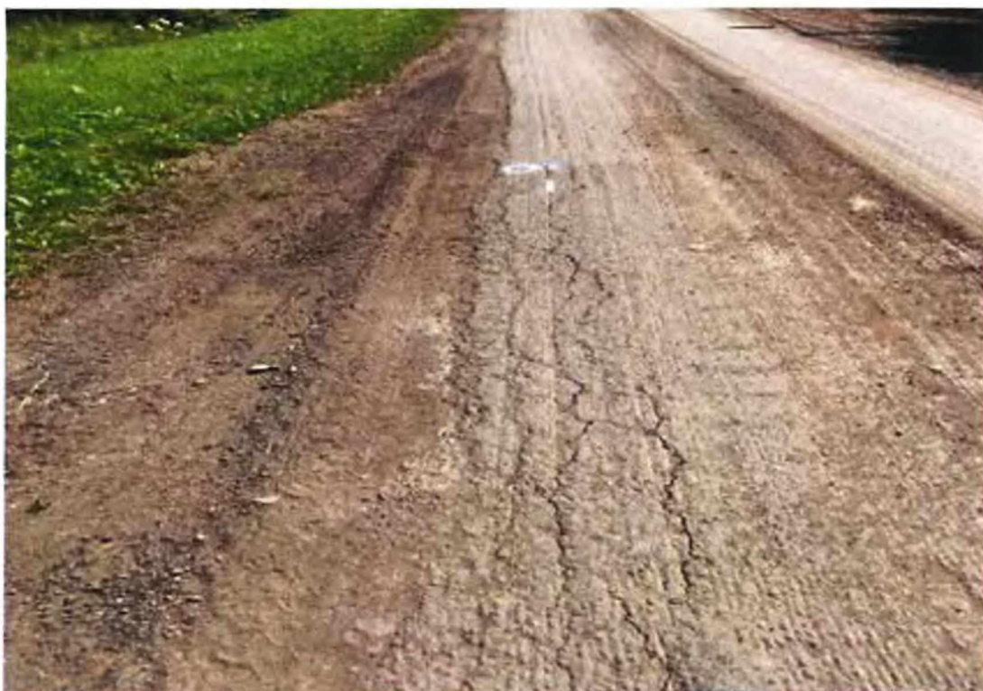
Charakteristické trhliny vyskytující se na všech úsecích
