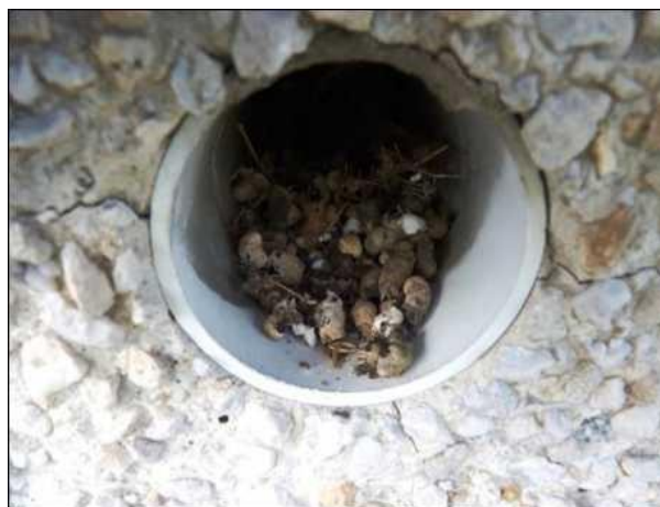
Trus drobných pěvců v ústí ventilačního otvoru
