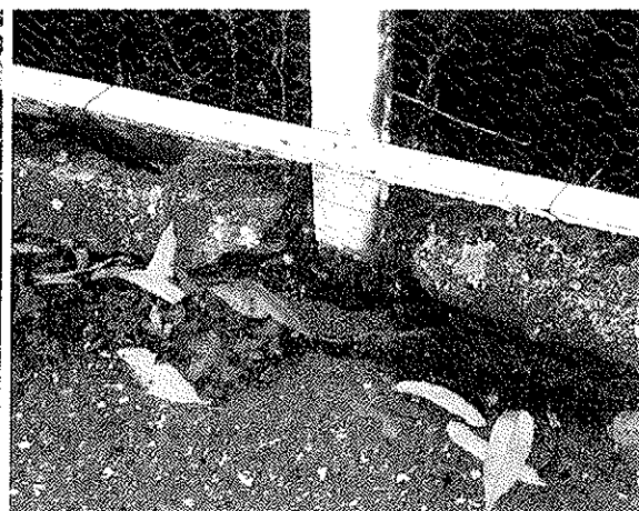
detail rozpadlé římsy v místě uchycení svislých sloupků
