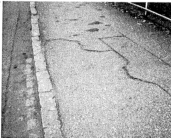
poškozený chodník po pravé straně po nevhodně provedené opravě
