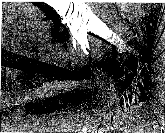
silně zkorodovaná výztuž krajního ztužujícího trámu NK
