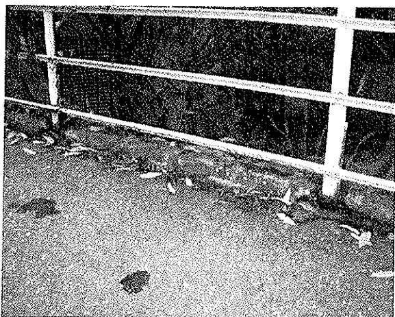
rozpadlá římsa po pravé straně v místě uchycení svislého sloupku zábradlí
