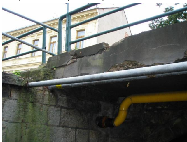
rozpadlý beton horní plochy řimsy vlevo
