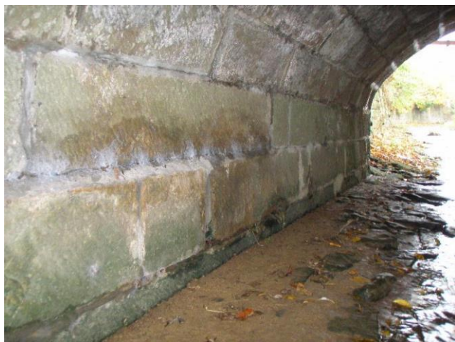
lokální malé kaverny a povrchově se rozpadající kamenné kvádry v úrovni hladiny
