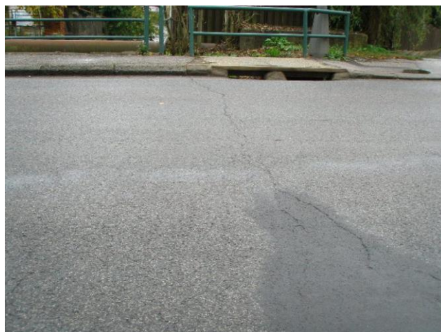
trhliny v živичném krytu vozovky na konci mostu
