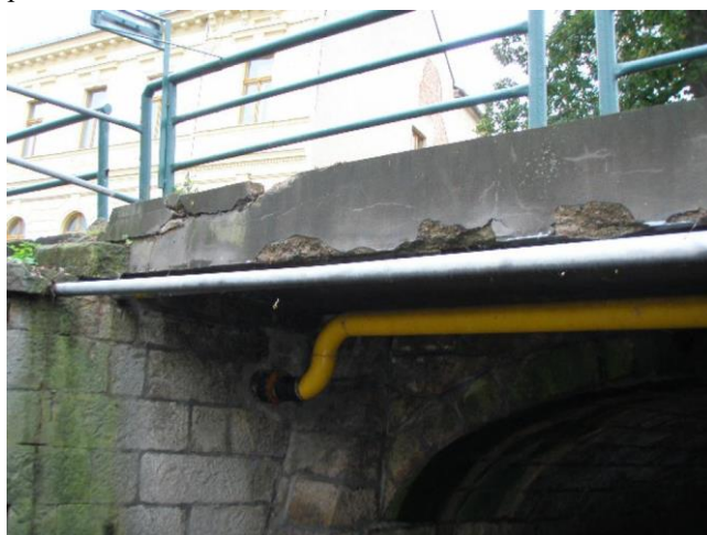
hloubkově degradovaný beton spodní hrany řimsy vlevo
