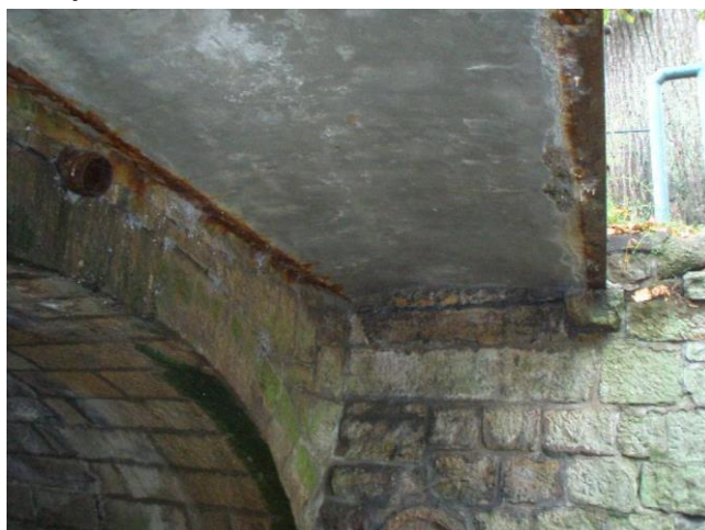
podhled chodníkové konstrukce a koroze odvodňovače
