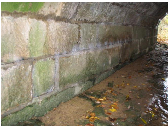
vodorovná trhlina mezi kamennými bloky opěry na konci mostu
