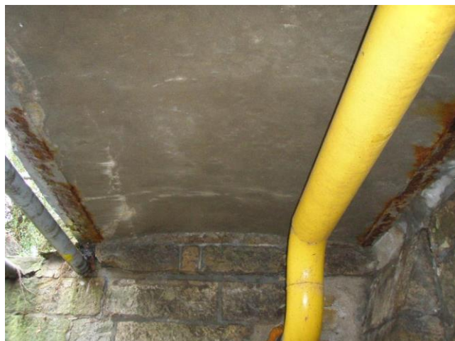
počínající koroze podhledu ocelových nosníků rozšíření NK
