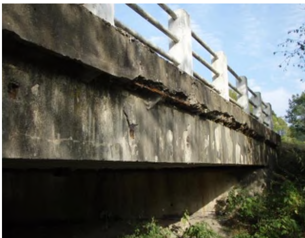
hloubkově degradovaný beton římsy vpravo
