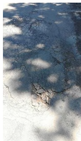
Stav krytu vozovky na mostě
