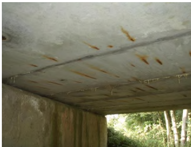
protékající spáry mezi nosníky s vápenitými usazeninami a krápníky
