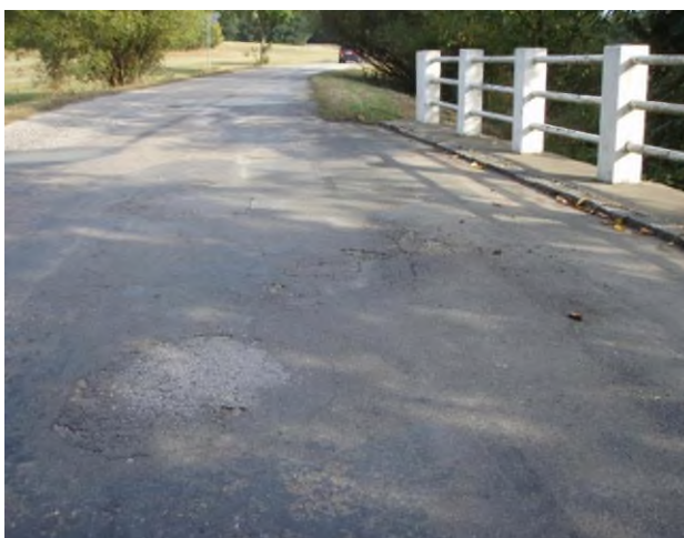
popraskaný živičný kryt vozovky
