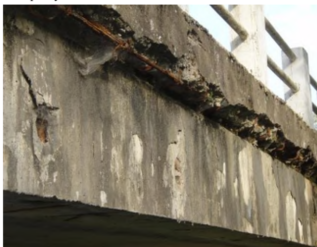
detail obnažené a téměř zkorodované výztuže římsy vpravo
