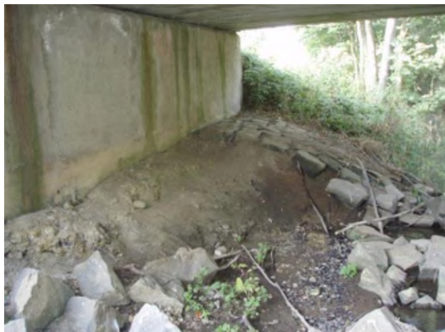
rozpadlé a odplavené kamenné zpevnění koryta vodoteče pod mostem
