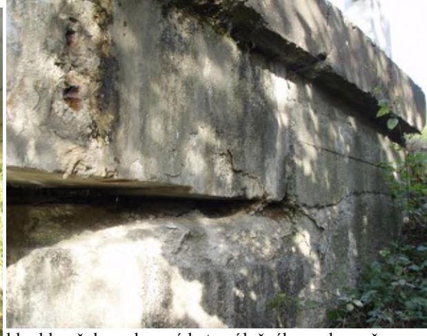
hloubkově degradovaný beton úložného prahu opěry na konci mostu vpravo
