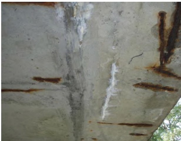
obnažená zkorodovaná výztuž na pohledu krajního nosníku
