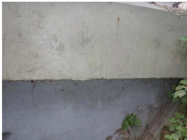
svislá trhlina na boku římsy vpravo
