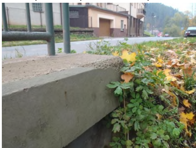
degradovaný beton na hraně římsy vpravo na konci mostu
