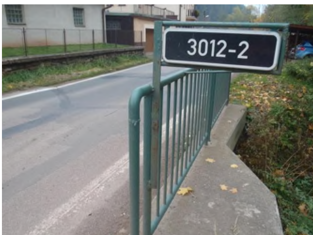
koroze rámečku evidenčního čísla
