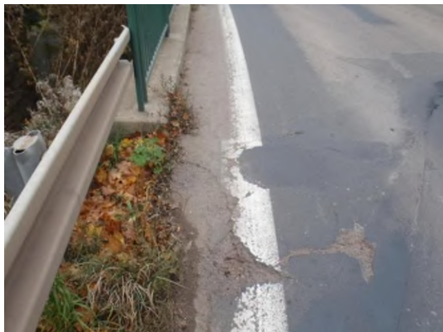
trhlina a výtluk v živichých vrstvách vozovky vlevo
