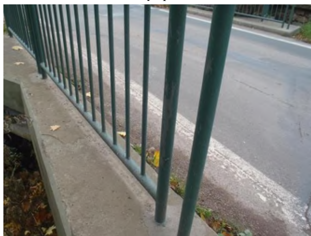
loupající se nátěr zábradlí
