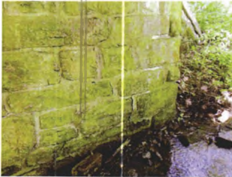
Popraskaná spárovací malta na pravoběžní opěře
