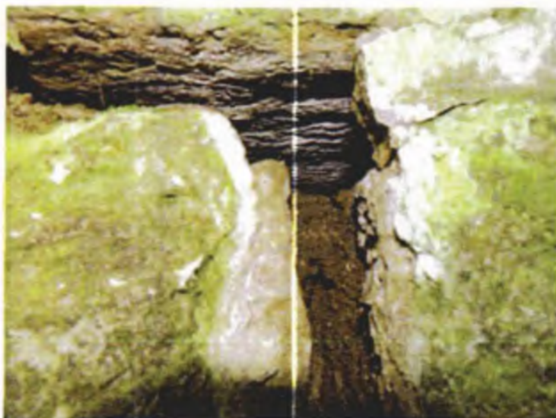
Detail předchozího snímku – nedostatečně vyplněné stykové spáry mezi kamennými kvádry
