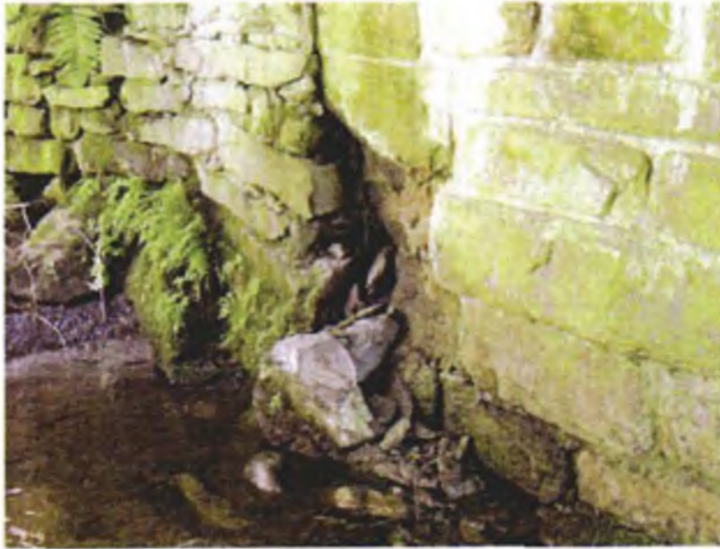
Jiný pohled na narušený nárožní kvádr
