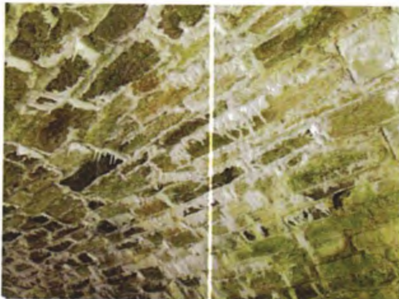
Četné průsaky srážkové vody zdívkem klenby
