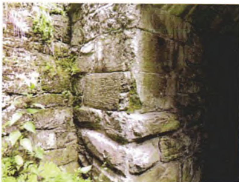
Narušený povrch betonu rohových kvádrů na levobřežní opěře
