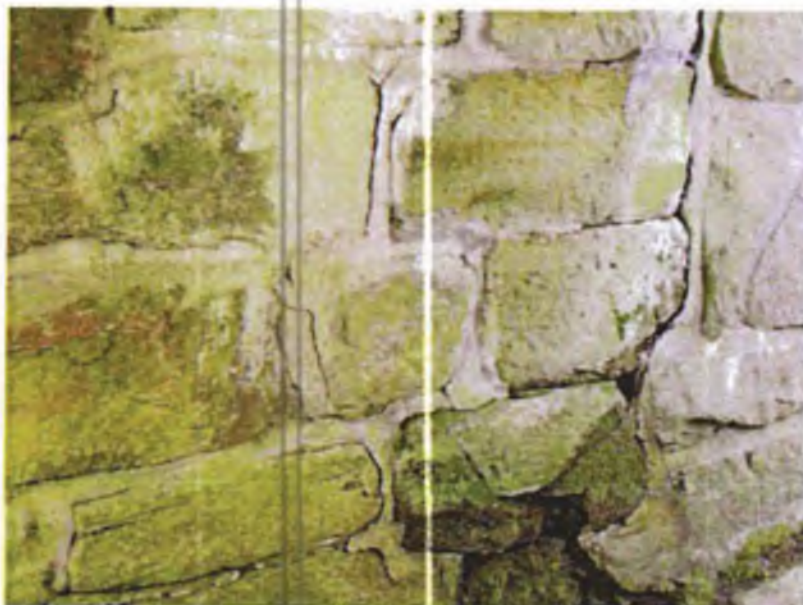
Popraskaná spárovací malta
