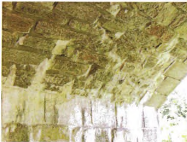
Protékání srážkové vody zdívm klenby
