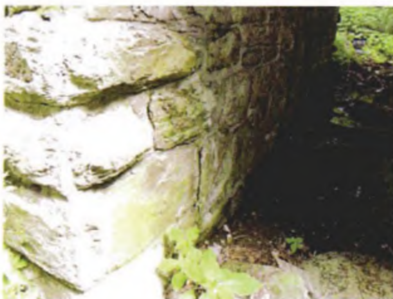
Popraskaná spárovací malta na pravobřežní opěře – možný pohyb zdících kvárů
