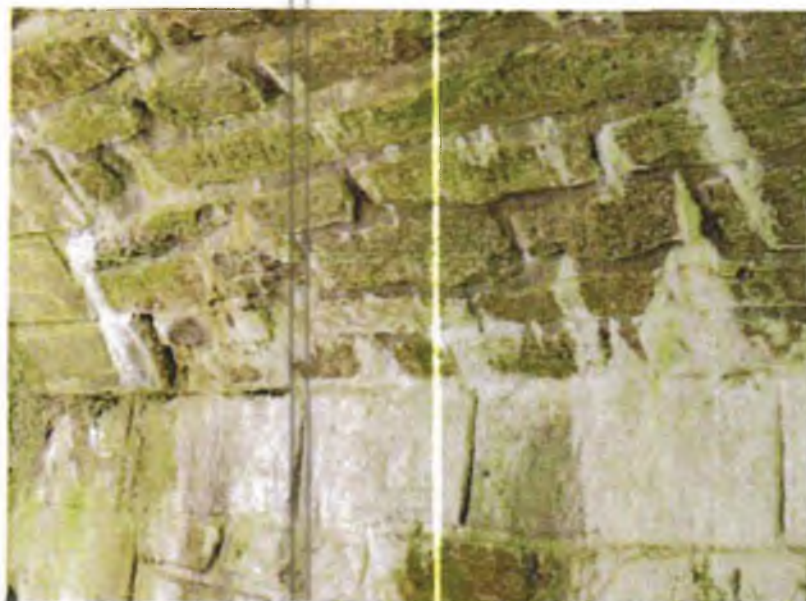
Protékání srážkové vody zdívem klenby
