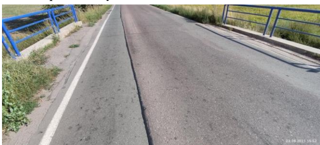
Stav krytu vozovky
