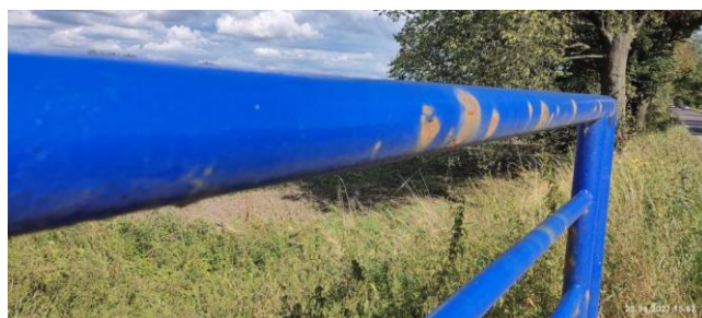
Stav nátěru pravého zábradlí1
