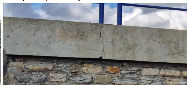
Svislá trhlina v levé římse
