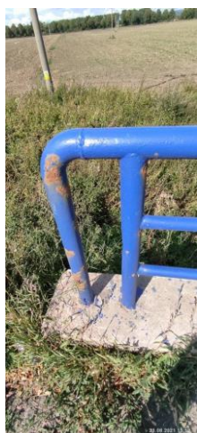
Stav nátěru pravého zábradlí
