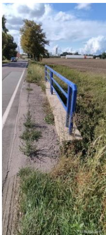
Pravá krajnice a chybí ev.číslo
