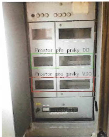
Rozvaděč RE vlevo od vstupních dveří
