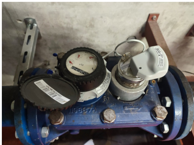
Vodoměr s instalovaným zařízením pro dálkový odečet
