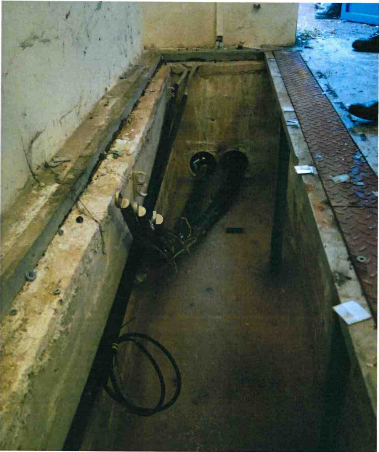
Pohled na stávající kanál s výskytem vody z průsaku stěnami
