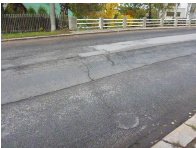
trhlina na začátku mostu
