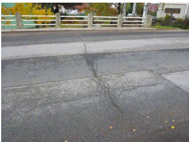
trhlina na konci mostu
