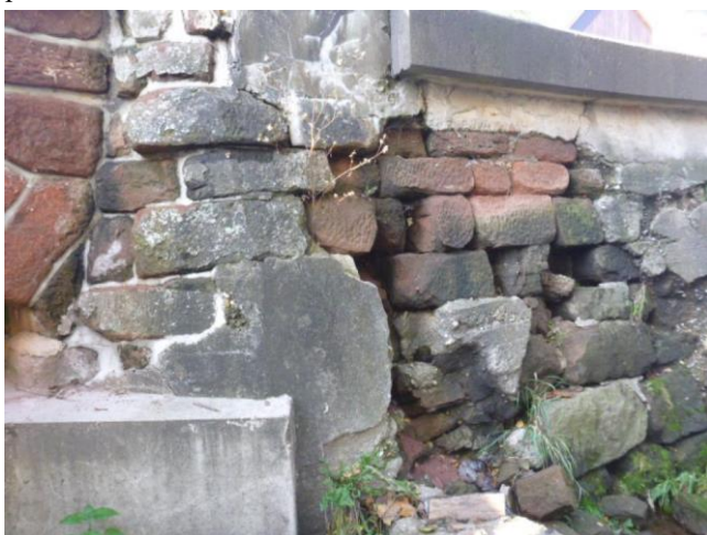
rozpad zdiva na začátku vlevo
