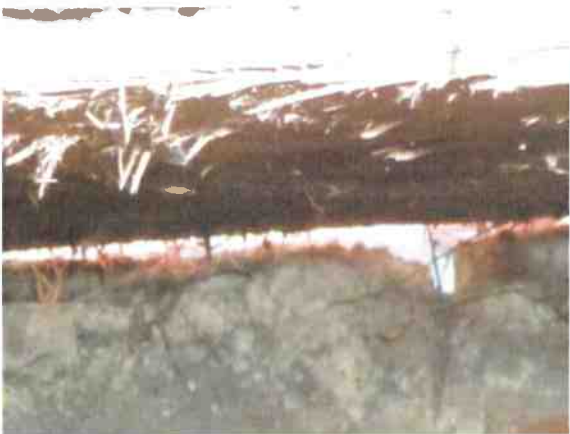
č.11 Spára mezi zdivem atiky a střeou
