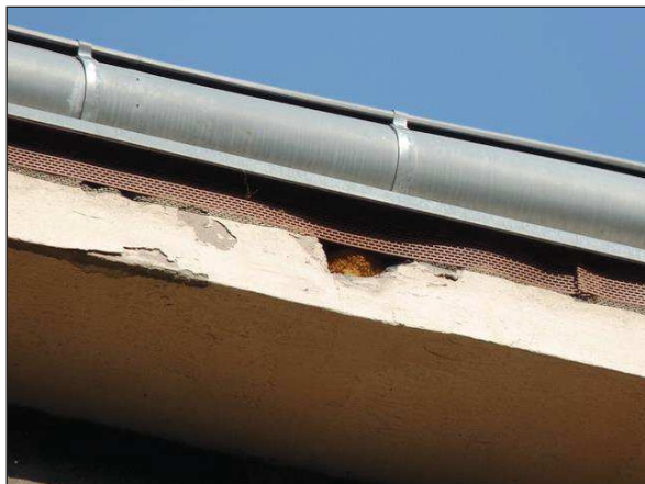
Detail poškození římsy – vletový otvor do hnízda
