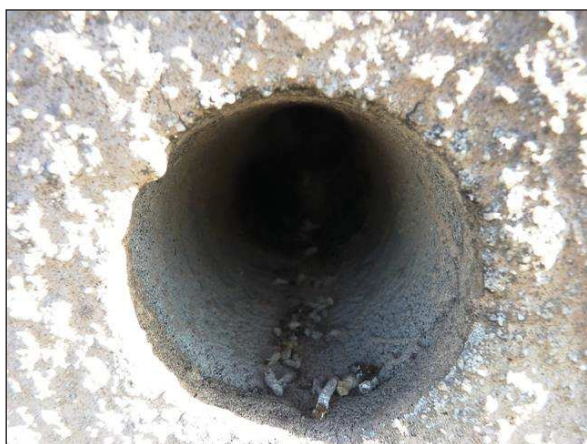
Trus drobných pěvců v ústí ventilačního otvoru
