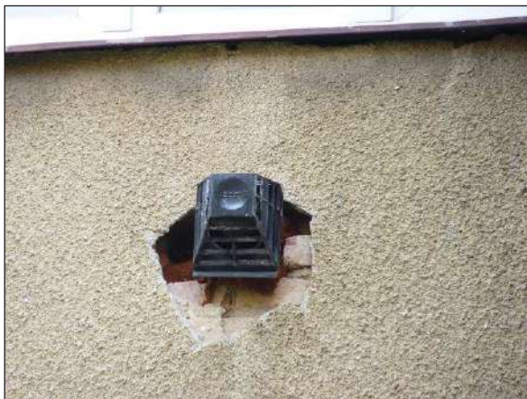
Nezačištěné okraje odvětrání podokenního topidla hnízdiště rorýse obecného
