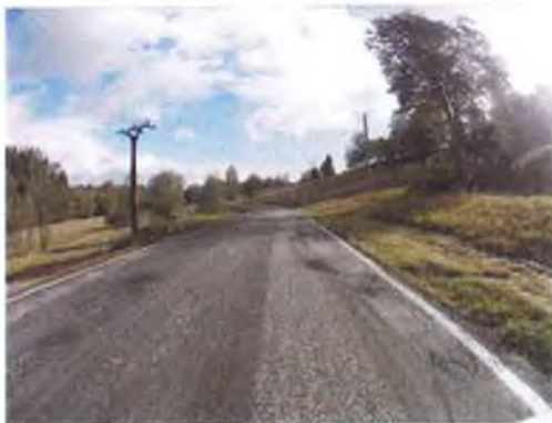
Vysprávky, mozaikové trhliny, ztráta mikrotextury
