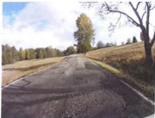
Vysprávký, hloubková koroze
