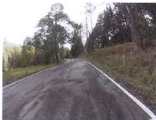
Mozaikové trhliny, hloubková koroze, vysprávka
