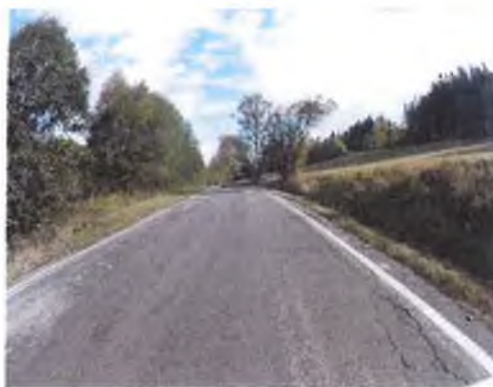
Mozaikové trhliny, ztráta mikrotextury
