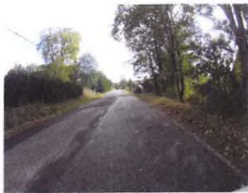
Ztráta mikrotextury, vysprávkvy, podélné trhliny
