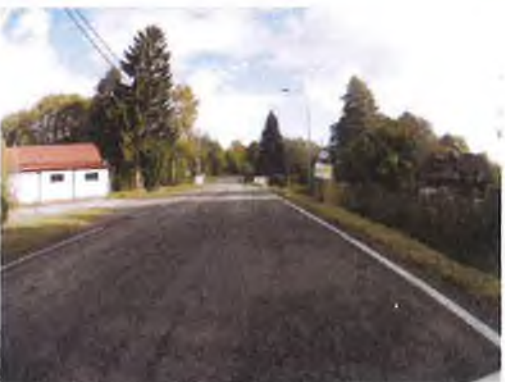
Hloubková koroze, vysprávkvy
