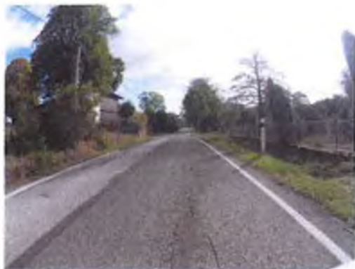
Mozaikové trhliny, ztráta mikrotextury
