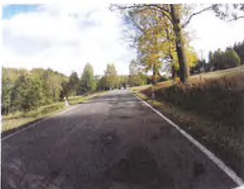
Mozaikové trhliny, výtluky, vysprávký
