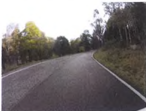
Ztráta mikrotextury, vysprávka
