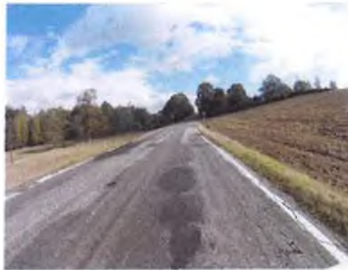
Mozaikové trhliny, ztráta mikrotextury, vysprávký
