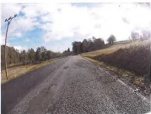
Hloubková koroze, vysprávky
