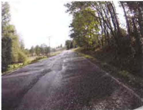
Hloubková koroze, vysprávky
