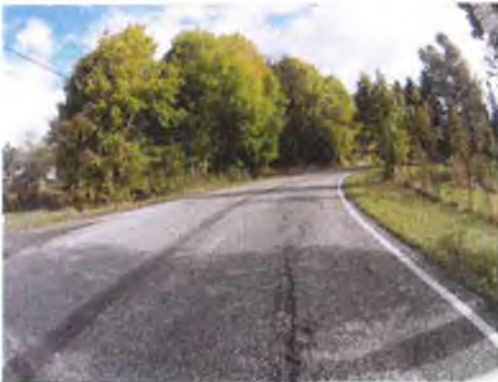
Podélná široká trhlina, hloubková koroze
