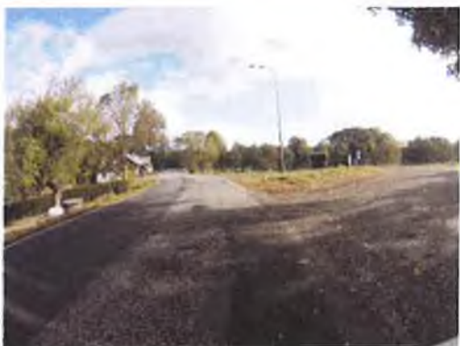
Hloubková koroze, vysprávký
