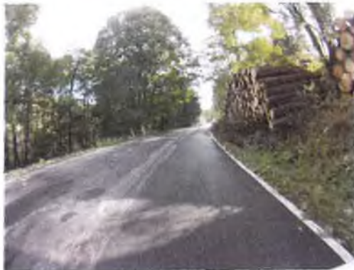
Vysprávky, ztráta mikrotextury
