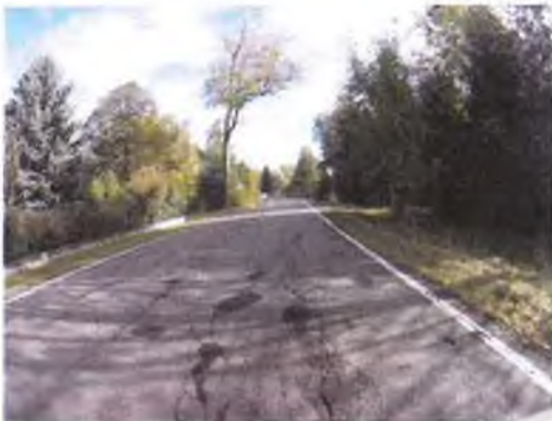
Ztráta miktrotextury, vysprávkvy, mozaikové trhliny
