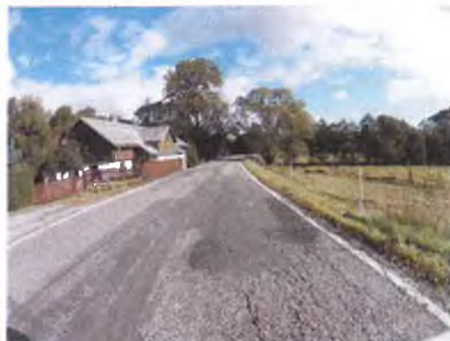
Mozaikové trhliny, vysprávký, ztráta mikrotextury
