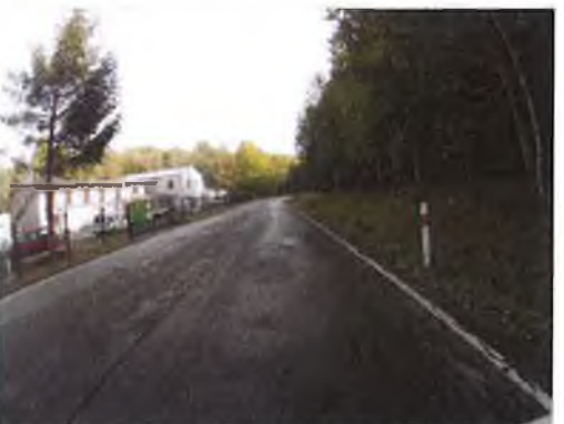
Hlubková koroze, vysprávký, mozaikové trhliny
