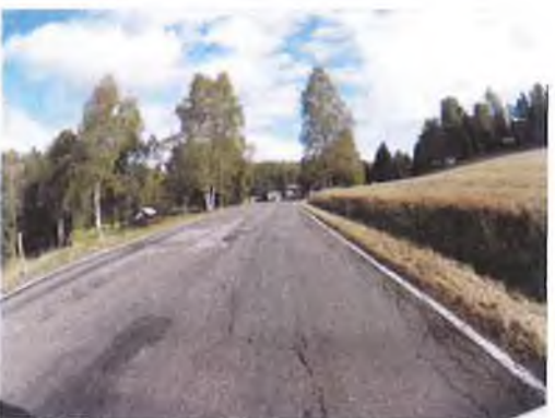
Mozaikové a podélné trhliny, vysprávký
