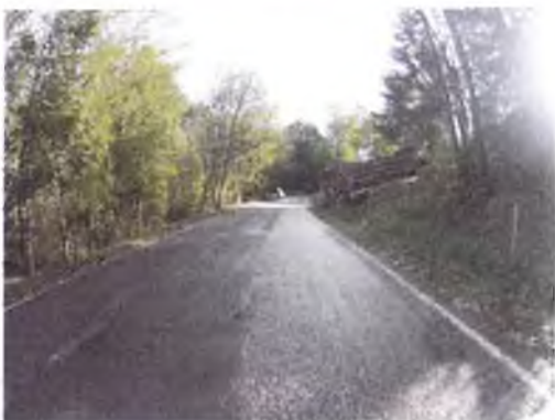
Vysprávky, ztráta mikrotextury, výtluk
