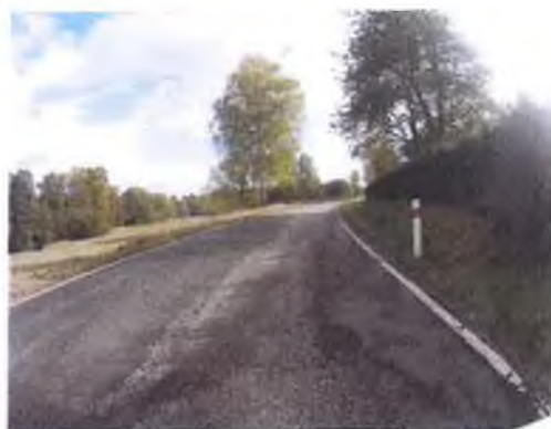
Ztráta miktrotextury, vysprávkvy, mozaikové trhliny
