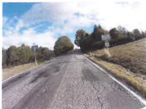
Mozaikové trhliny, ztráta mikrotextury, vysprávký
