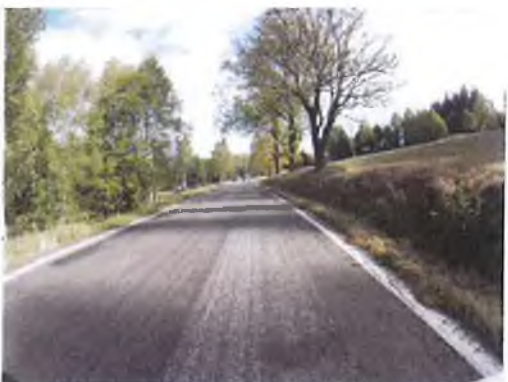
Ztráta mikrotextury, mozaikové trhliny
