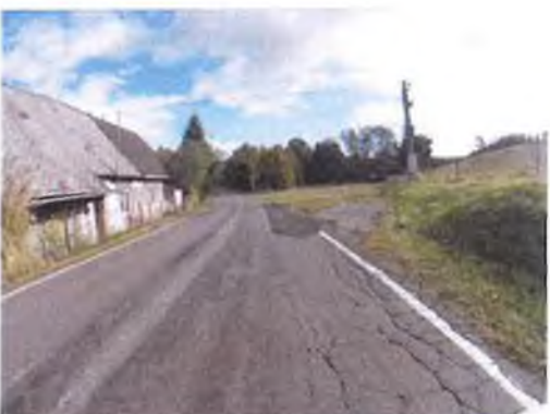
Síťové trhliny, ztráta makrotextury, vysprávkvy
