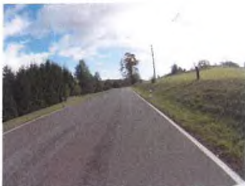
Podélné trhliny, ztráta makrotextury
