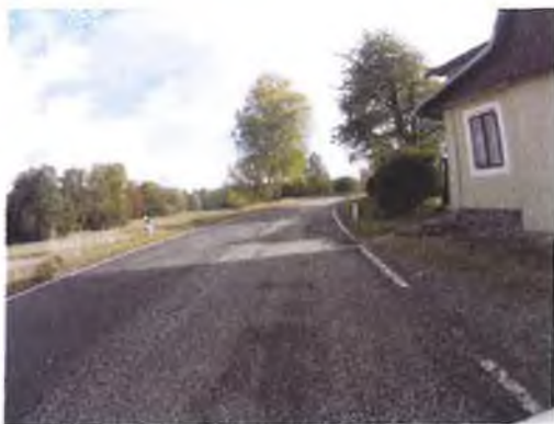
Ztráta miktrotextury, vysprávkvy
