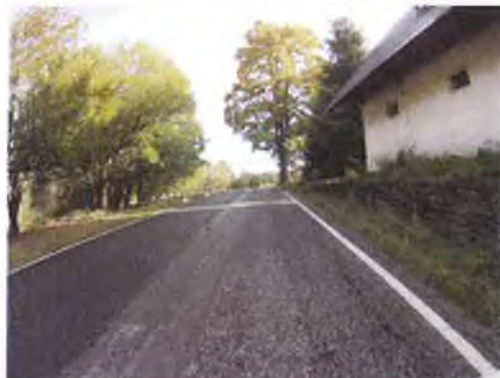
Mozaikové trhliny, hloubková koroze, vysprávký
