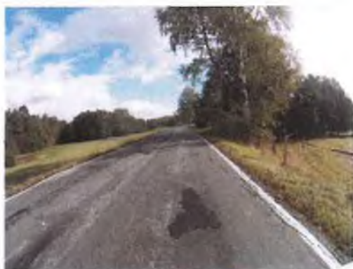
Mozaikové trhliny, vysprávký, ztráta mikrotextury
