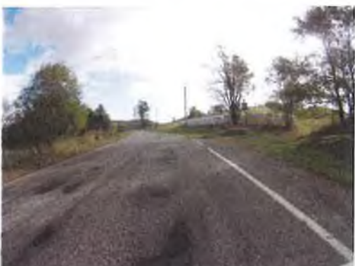
Vysprávkvy, ztráta miktrotextury, podélné trhliny
