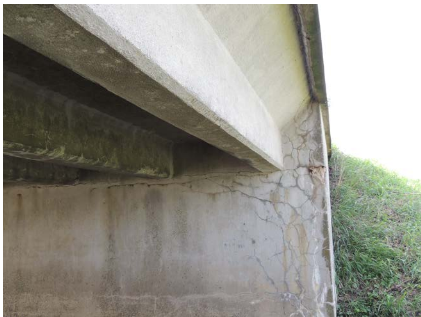
Pohled na vodorovnou stykovou spáru mezi opěrou a deskou směr Králíky
