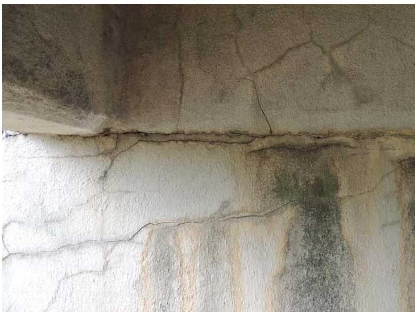
Styková spára mezi opěrou a deskou, popraskaná omítka
