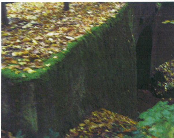
křídlo na začátku mostu vpravo porostlé mechem
