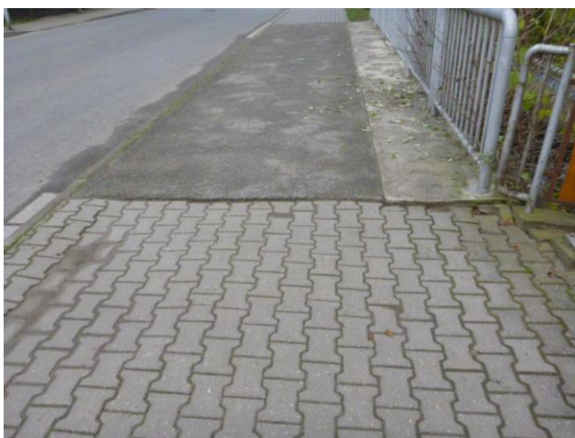
propadlý chodník na začátku vpravo
