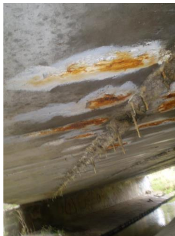
Koroze sanovaných třmínků nosníků
