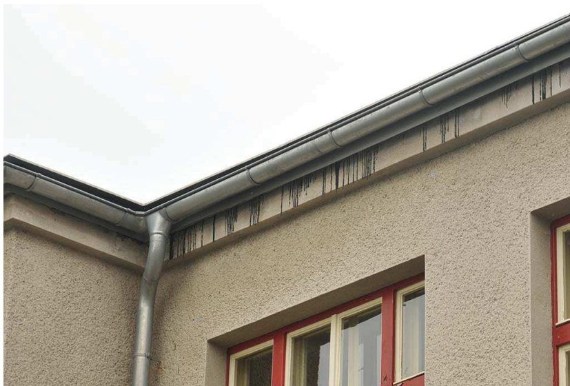
Detail nových okapů s absencí štěrbin pod okapnicí a střešní krytinou.
