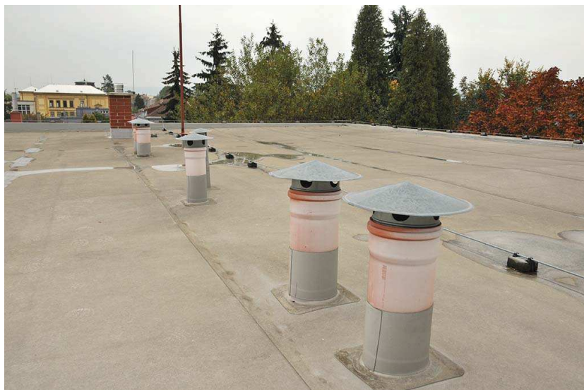
Ventilační komínky kryté stříškou a zábranou proti vniknutí živočichů.
