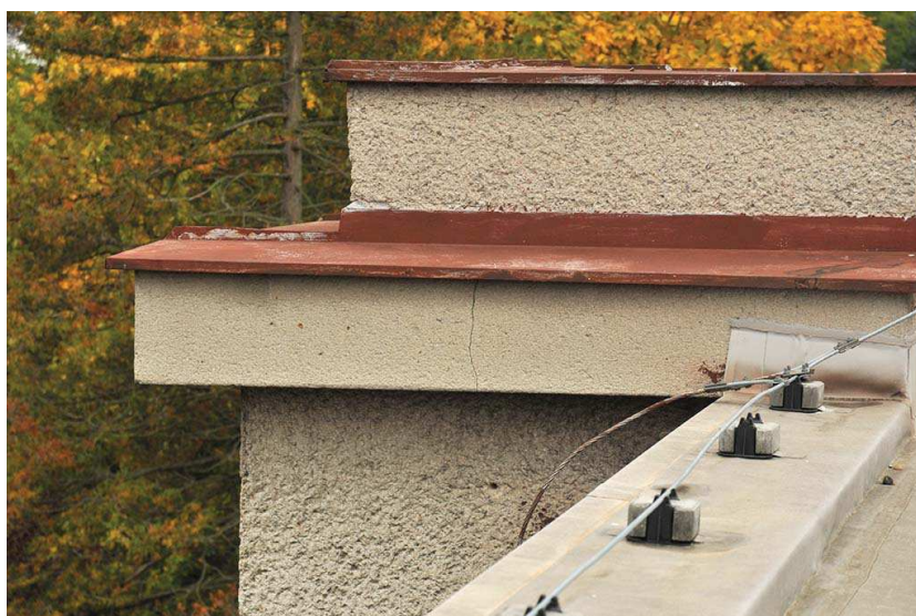
Oplechování říms je z menší části původní, tvořené plechem s nátěrem, avšak bez dutin pod plechem.
