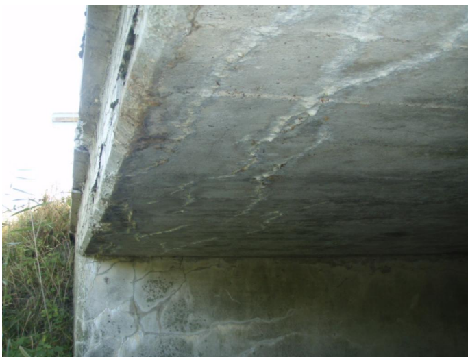
popraskaný a zvodnělý povrch betonu v pohledu mostovky a opěry po levé straně na konci mostu
