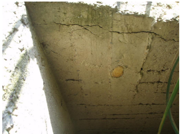
detail popraskaného betonu a obnažené výztuže v pohledu nosné konstrukce po pravé straně mostu
