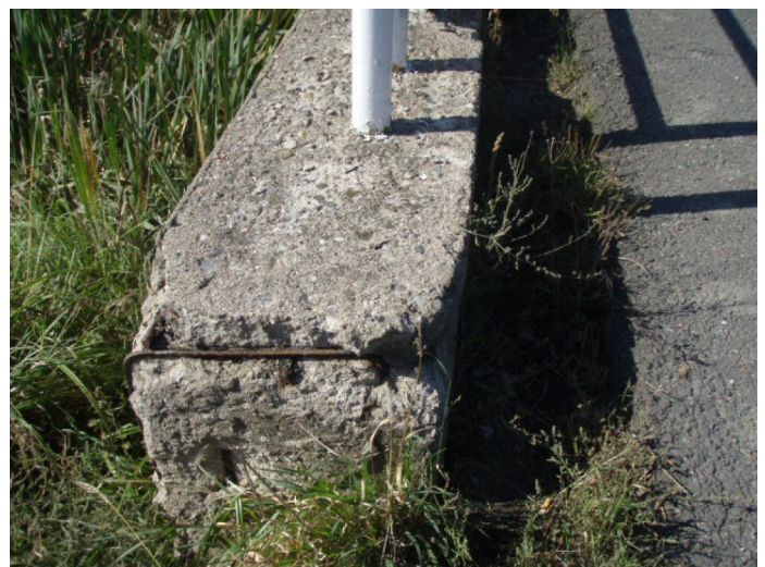
poškozený beton a obnažená výztuž římsy
