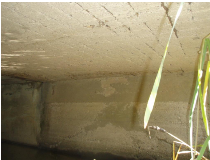
obnažená výztuž nosné konstrukce v pohledu pravé strany mostu
