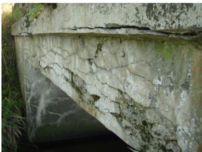
popraskaný povrch betonu boku levé strany mostu
