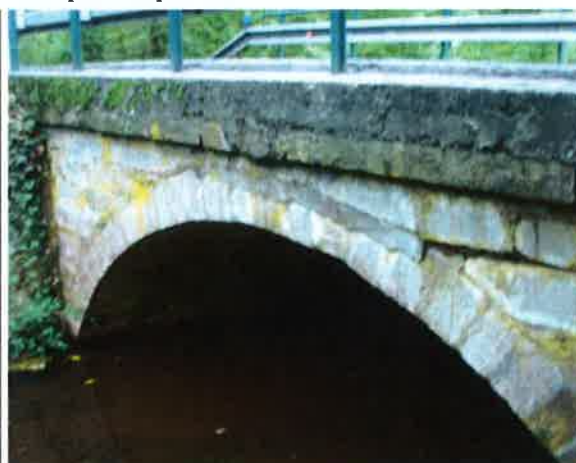
degradovaný beton římsy a chybějící spárování vpravo
