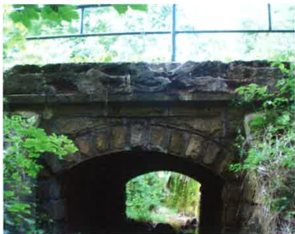
hloubkově rozpadlý beton římsy vpravo
