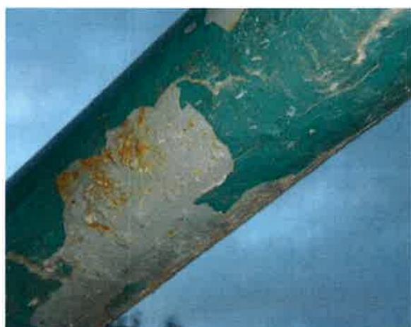
detail počínající koroze zábradlí
