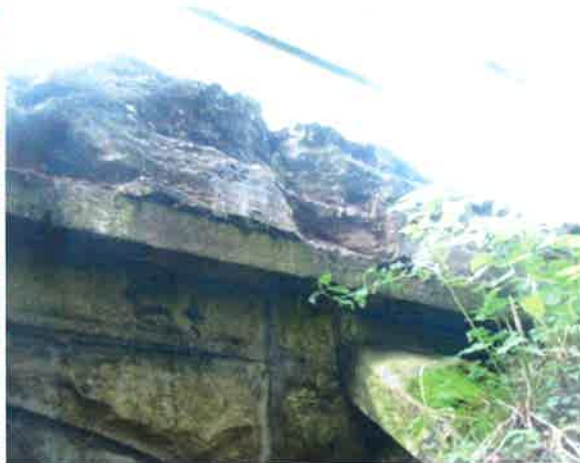
detail rozpadlé římsy
