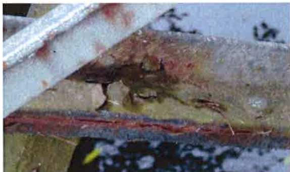
koroze ocelové konstrukce
