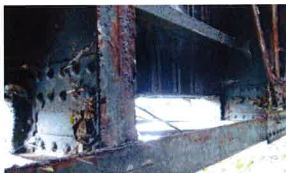
koroze ocelové konstrukce
