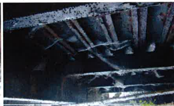
koroze mostin v pohledu NK
