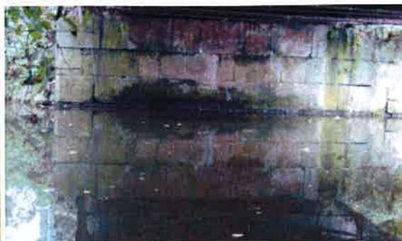
chybí spárování mezi kvádry opěry na zač.mostu
