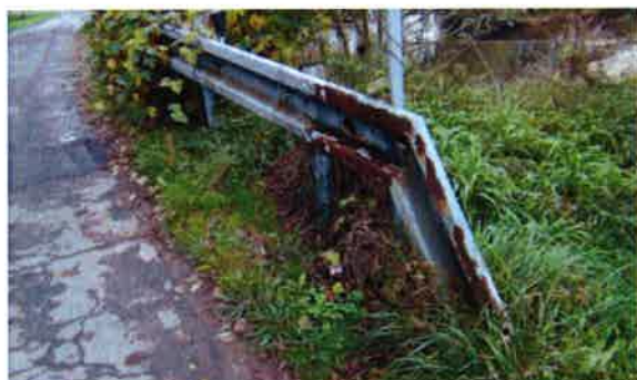
koroze svodidla na konci mostu vlevo
