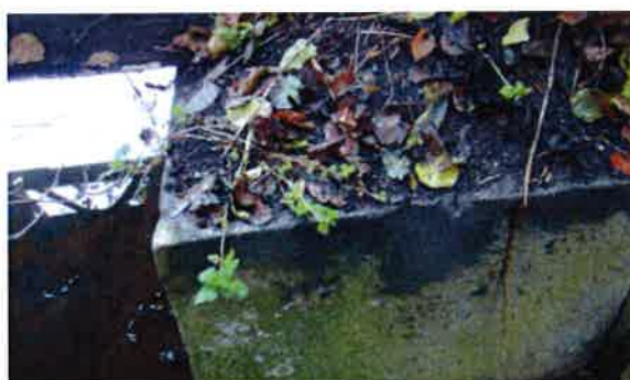
huminózní zemina se zakořeněnou vegetací na horní ploše opěry na konci mostu
