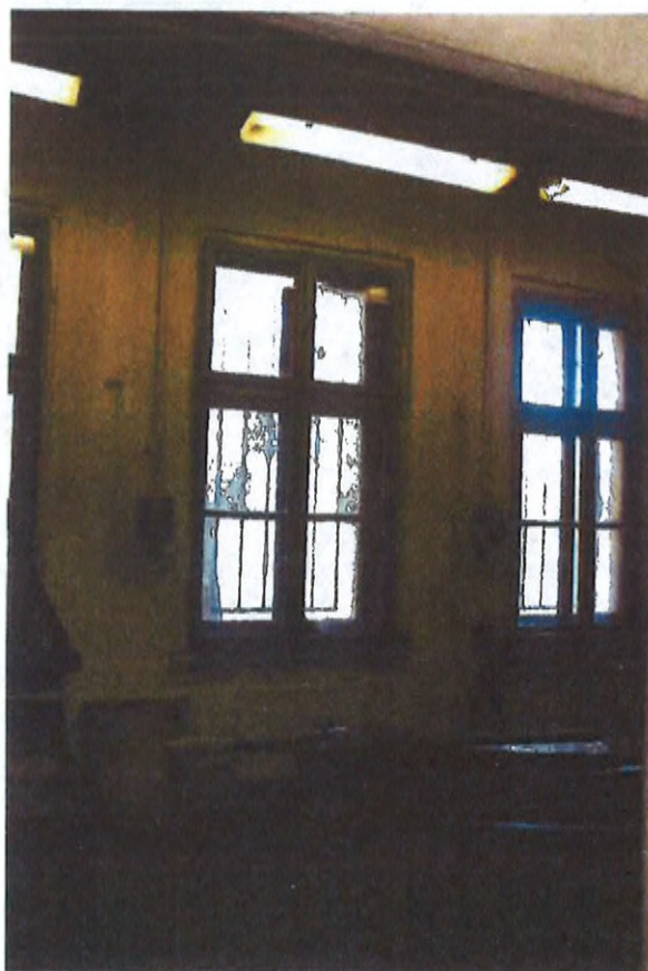
Zastaralá, netěsná okna
