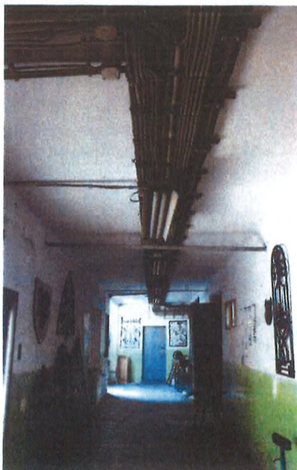
Zastaralá elektroinstalace a osvětlení
