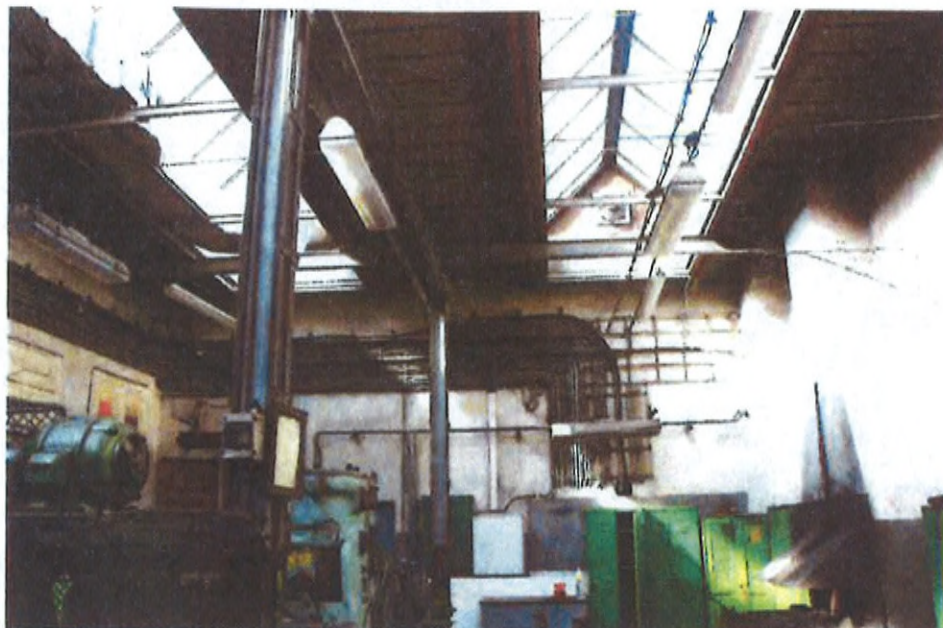
Nezateplené stropní světlíky
