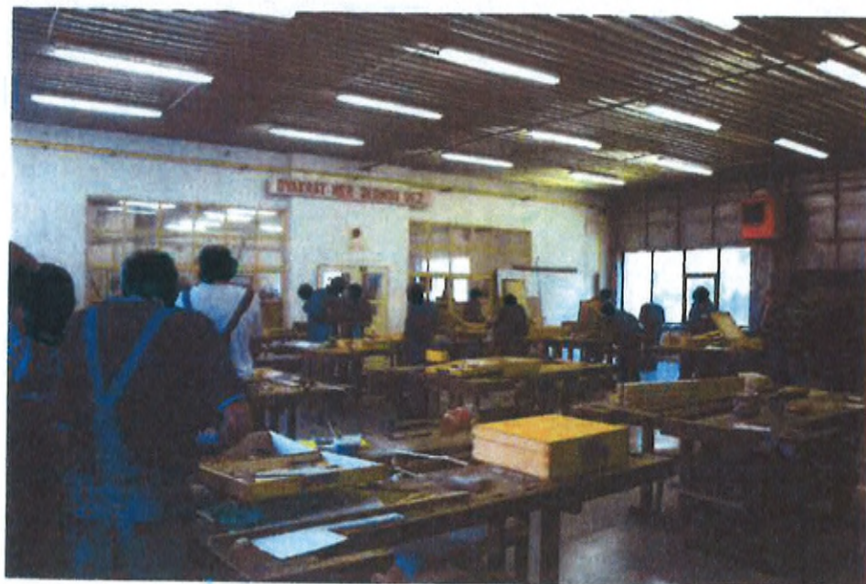
Nedostatečné zateplení stěn a stropů
