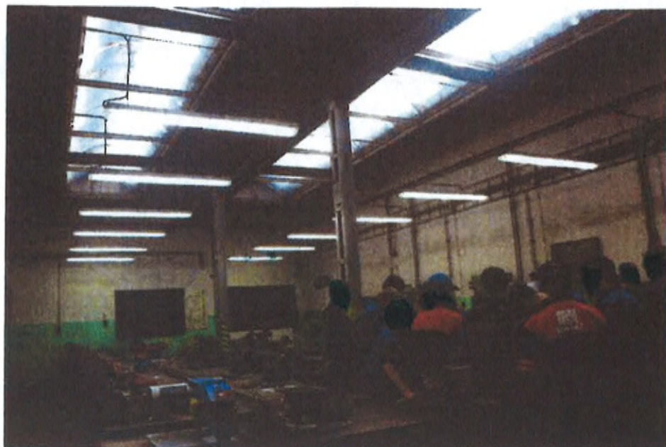
Provizorní nedostatečné zateplení stropů
