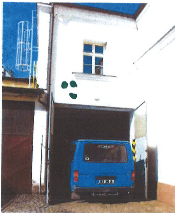
Rozměrově nevyhovující vjezd do opravárenské dílny
