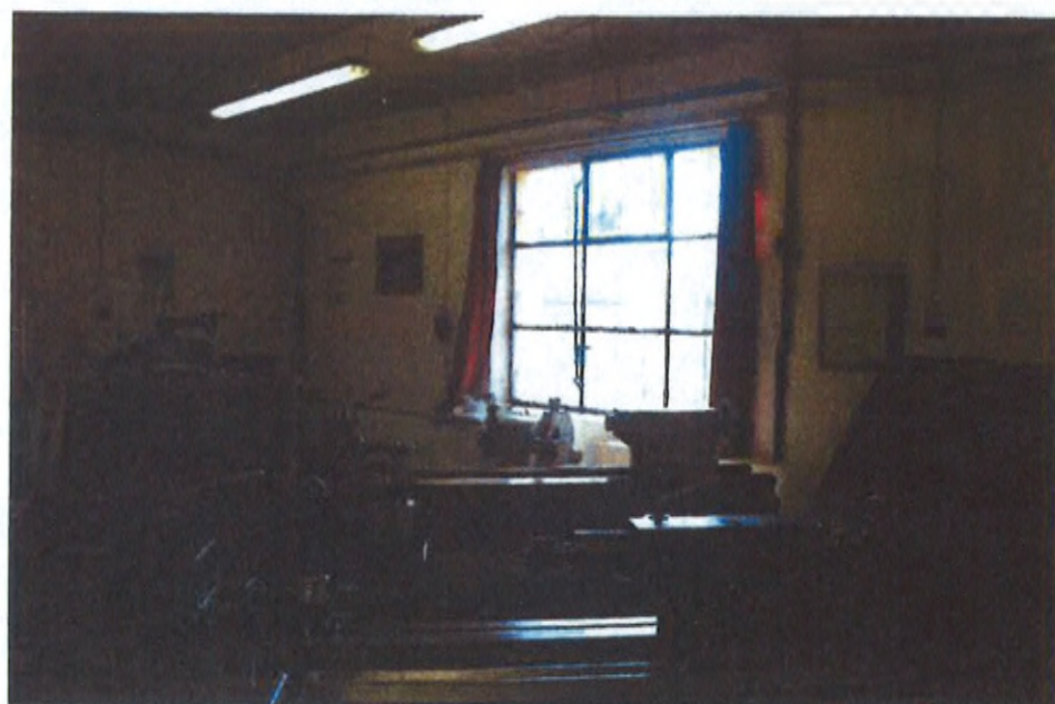
Jednoduchá, netěsná okna
