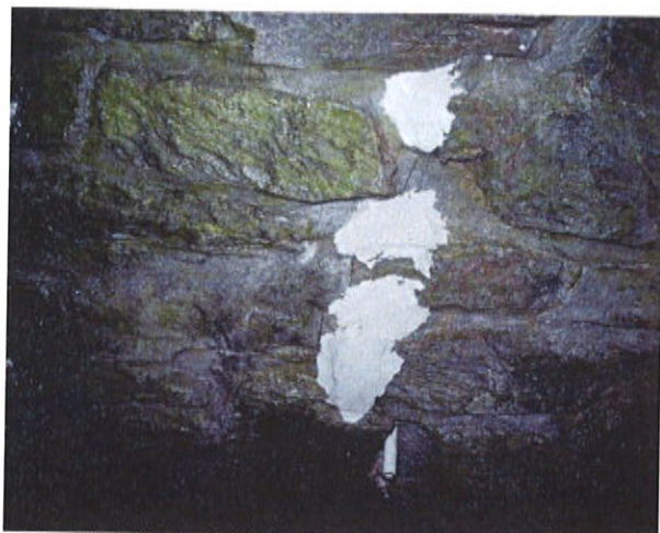
Sádrové deformační koláčky v místě rozeptění-detail
