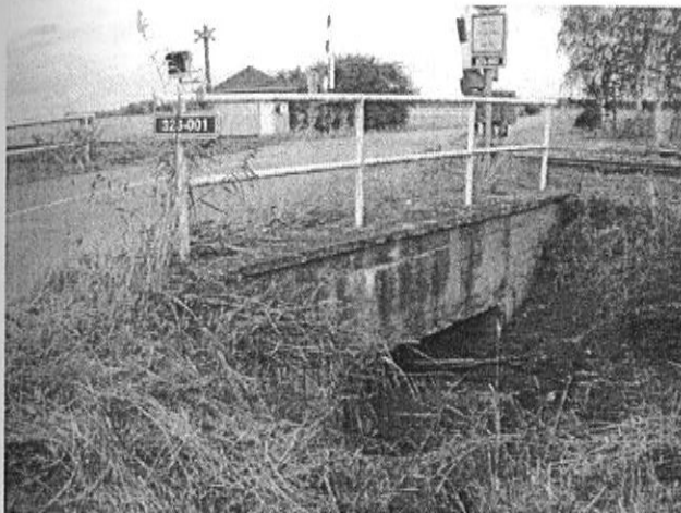
vodorovná trhlina s vápenitými inkrustacemi na čelní zdi vpravo
