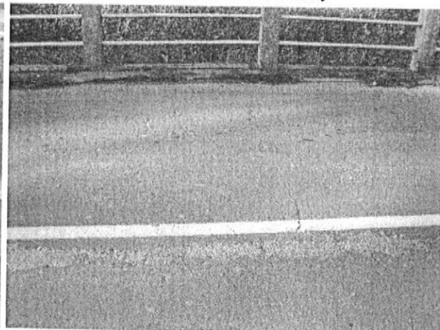
trhliny v živičném krytu
