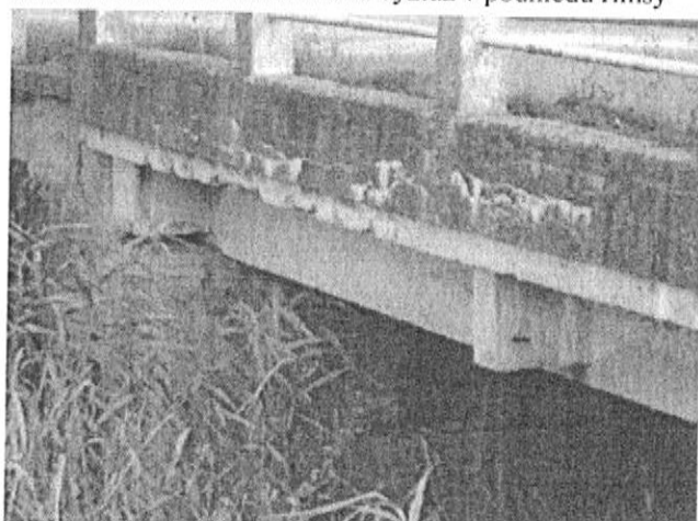
všesměrné praskliny na boku římsy vlevo
