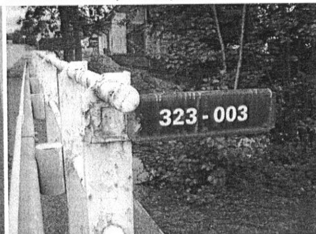
zkorodovaná tabulka evidenčního čísla
