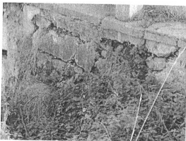
rozpadlý beton křídla
