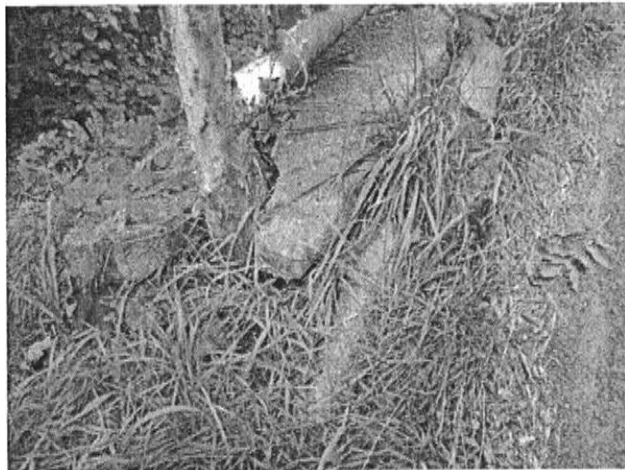
rozlámaný beton římsy vpravo
