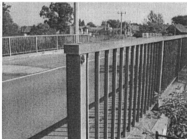
chybějící tabulka evid.číslo na začátku mostu
