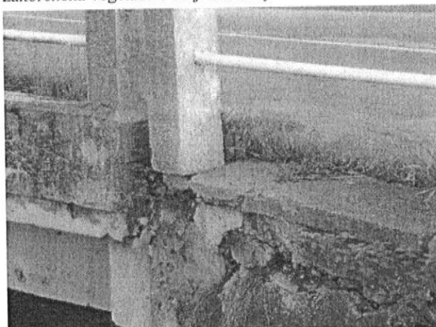
rozpadlý beton křídla na zač.mostu vlevo
