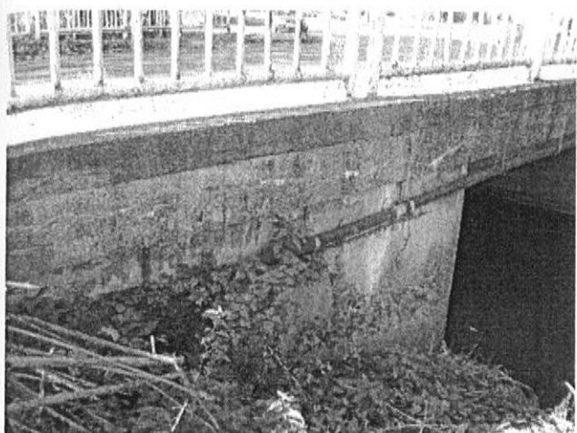
praskliny v římse a na boku NK s vápenitými inkrustacemi
