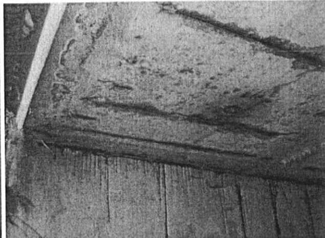
detail zkorodované výztuže na pohledu NK
