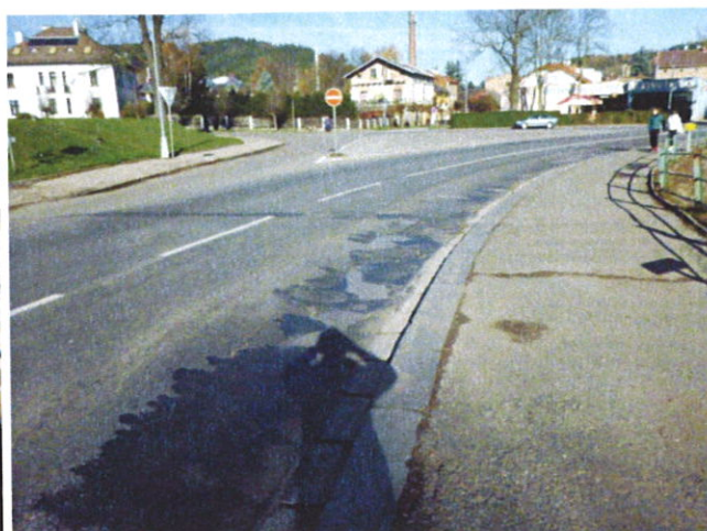
poruchy krytu vpravo
