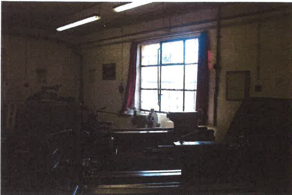
Jednoduchá, netěsná okna
