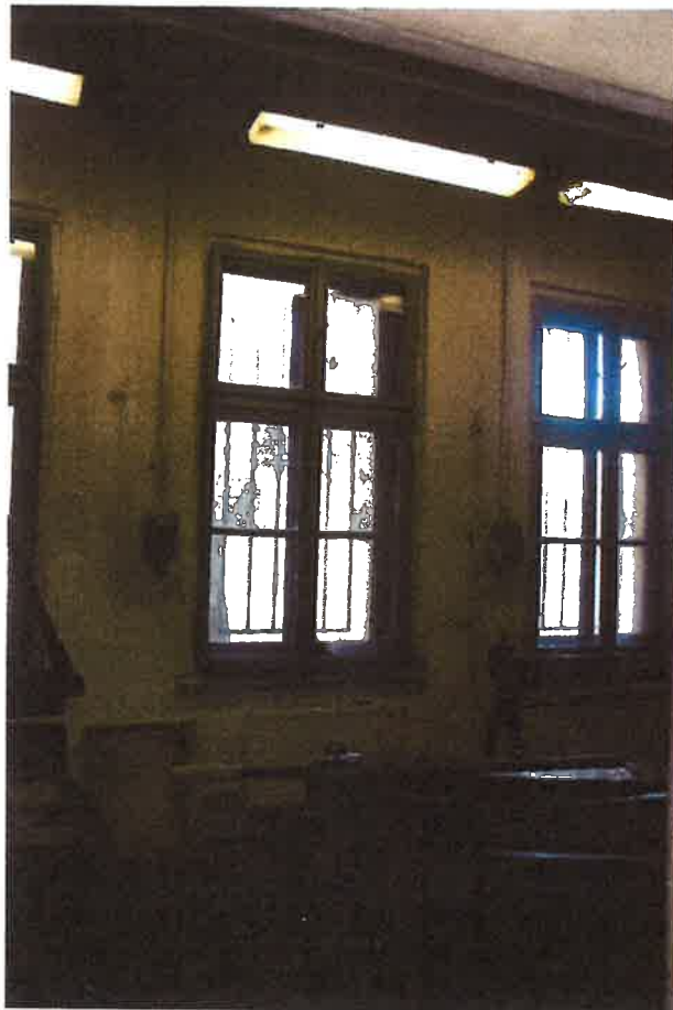
Zastaralá, netěsná okna
