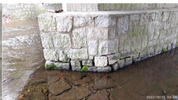
poškozené spárování středové podpěry v úrovni hladiny vodoteče
