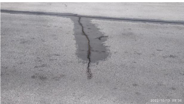
Trhlina ve vozovce
