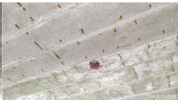
Obnažené korodující třmínky výztuže na pohledu NK
