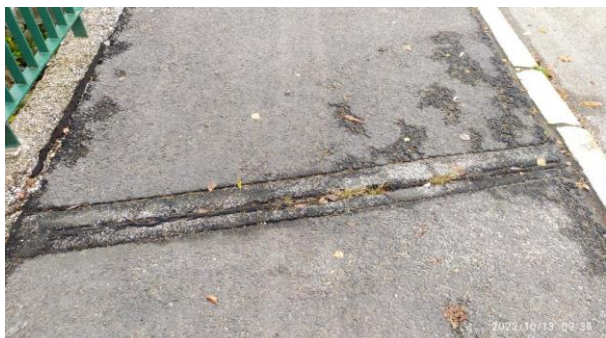
Dilatace v chodníku vlevo uprostřed
