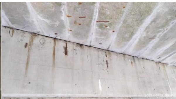
Obnažená výztuž na úložném prahu středové podpěry
