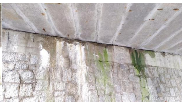
Zatékání na OP2
