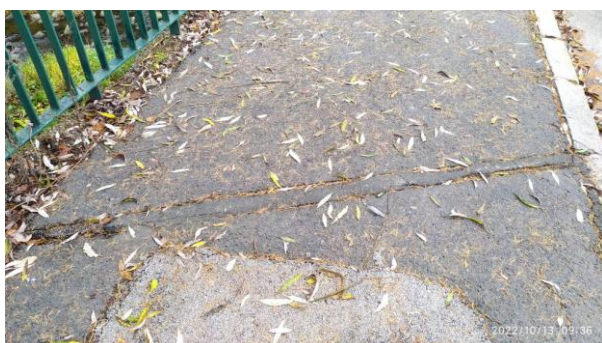
Dilatace na začátku chodníku vlevo
