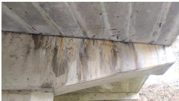
Inskrustace na úložném prahu středové podpěry
