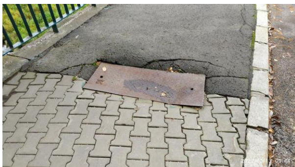
poškozený plech v chodníku vlevo na konci mostu - v místě dilatace
