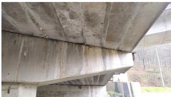
zatékání na úložný práh středové podpěry
