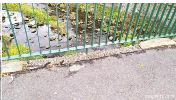
Degradace ebetonu římsy vlevo
