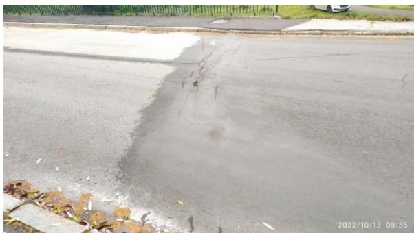
Trhlina ve vozovce na začátku mostu
