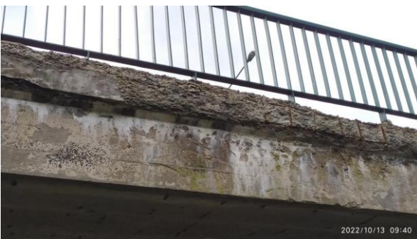
Rozpad římsy vlevo
