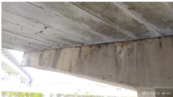
Zatékání na úložný práh středové podpěry
