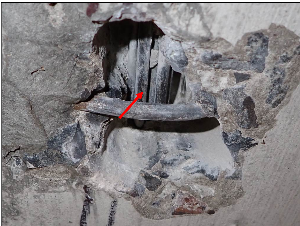
Foto 3: Detail sondy P3 – předpínací výztuž na spodním líci nosníku č. 10, poloha viz Příloha 1. Na předpínací výztuži nebyla nalezena koroze. Kanálek zcela vyplněn injektážní směsí. Krytí předpínací výztuže cca 35 mm.
