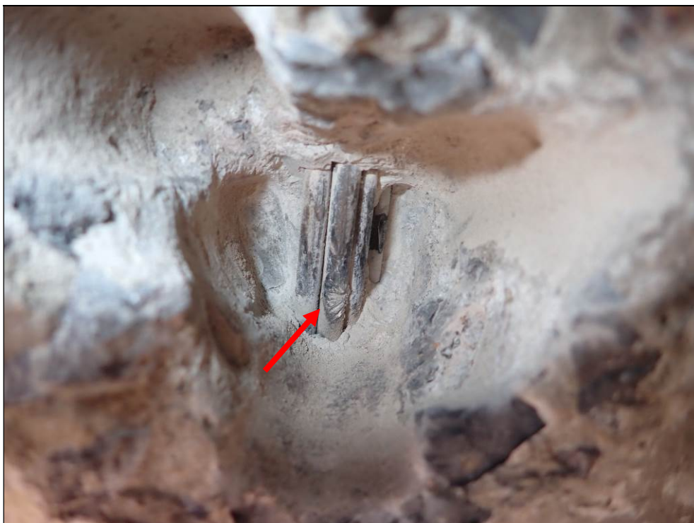
Foto 2: Detail sondy P2 – předpínací výztuž na spodním líci nosníku č. 10, poloha viz Příloha 1. Na předpínací výztuži nebyla nalezena koroze. Kanálek zcela vyplněn injektážní směsí. Krytí předpínací výztuže cca 50 mm.
