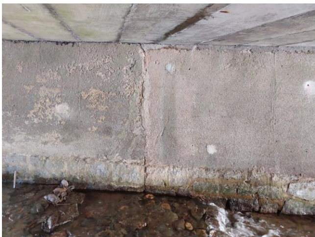
trhlina v OP2
