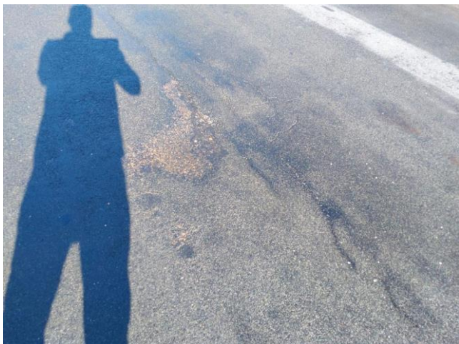
porucha vozovky na zacatku mostu
