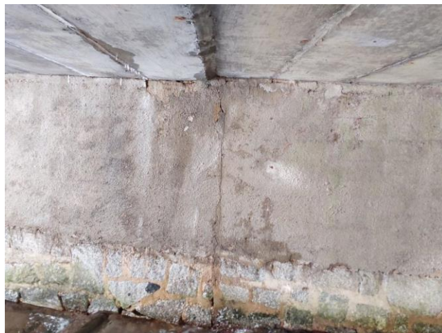
trhlina v OP1
