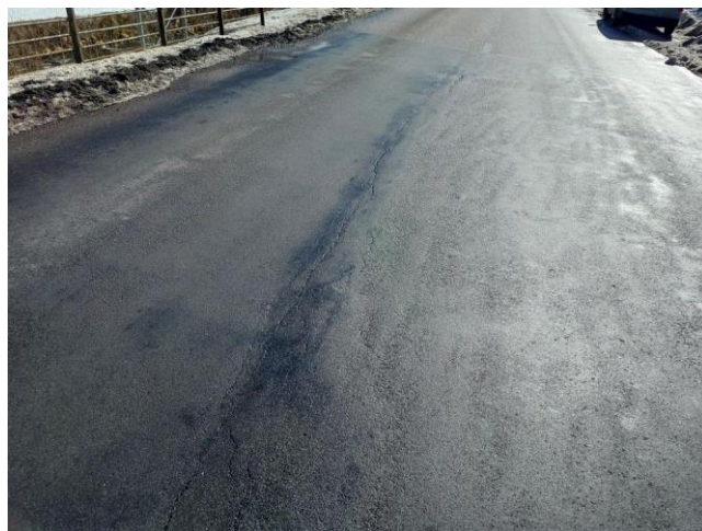
podelna trhlina ve vozovce v ose mostu
