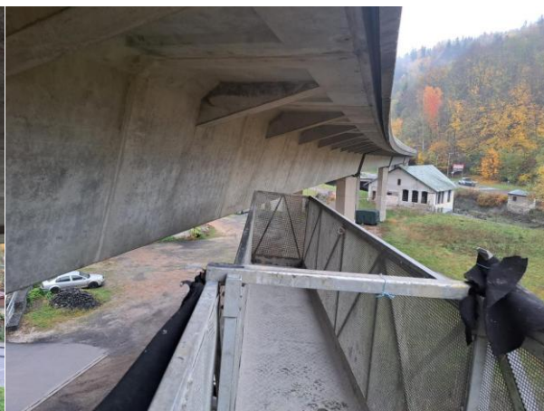
mostní pole č. 2_podhled konzoly vpravo
