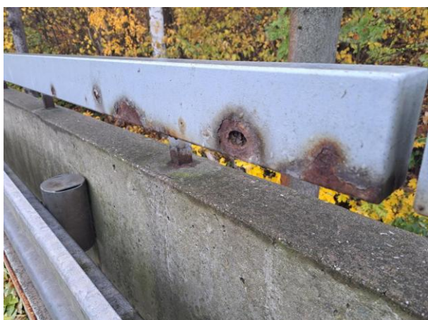
rozvoj korozí_madlo zábradelních svodidel
