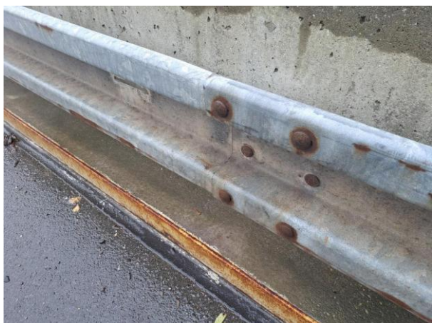
korozí spojovacího materiálu svodidel
