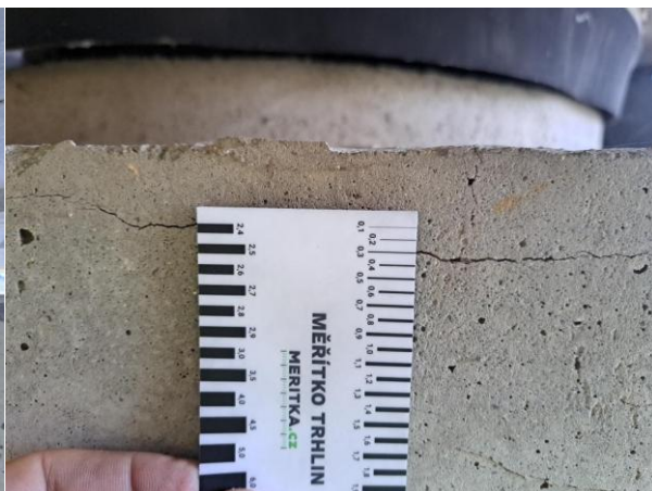
trhlina_hlava pilíře P7_vlevo
