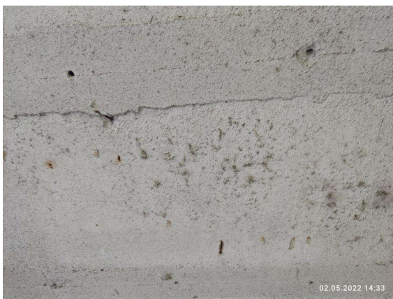
Lokálně obnažené třmínky na podledu NK
