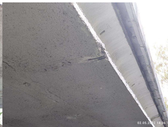
Lokálně poškozená hrana nosníku
