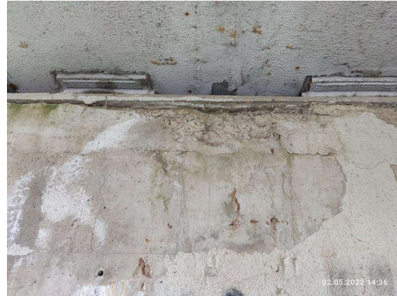
Trhliny v podpěře P2 a degradace betonu
