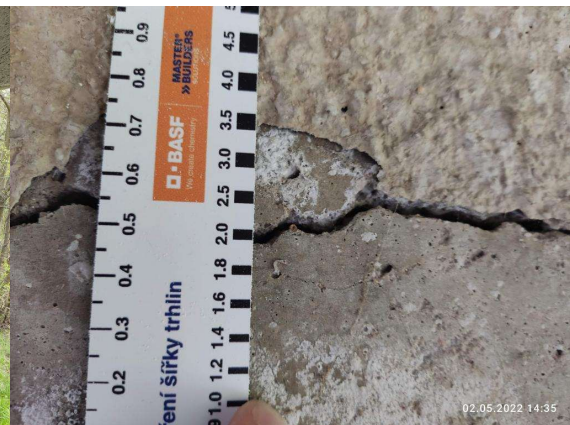
Detail trhliny v podpěře P2
