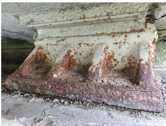
Koroze ložiska na opěře OP1 vlevo
