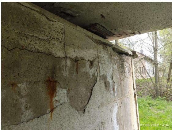
Trhliny v podpěře P2 a odpadlá omítka
