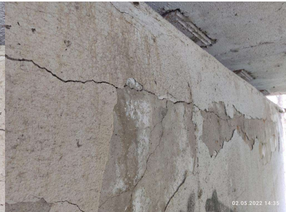
Trhliny v podpěře P2 a odpadlá omítka
