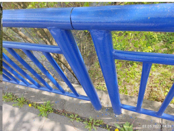
Stav nátěru pravého zábradlí
