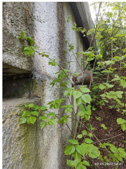
Levé křídlo na začátku mostu (K1)
