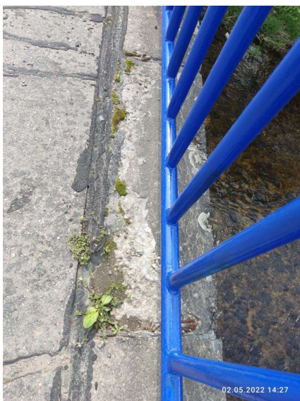
Degradace betonu levé římsy
