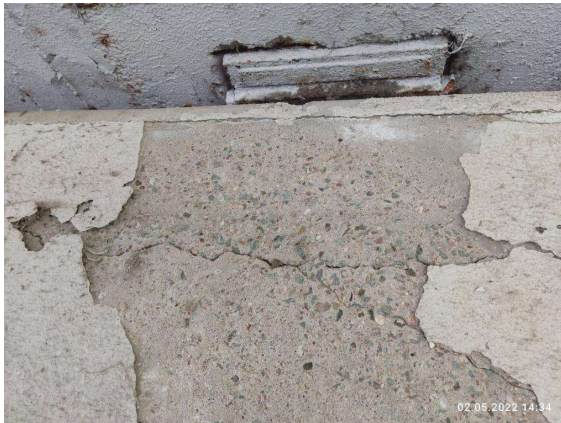
Trhliny v podpěře P2 a odpadlá omítka
