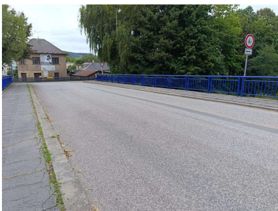
Stav krytu vozovky na mostě (3)
