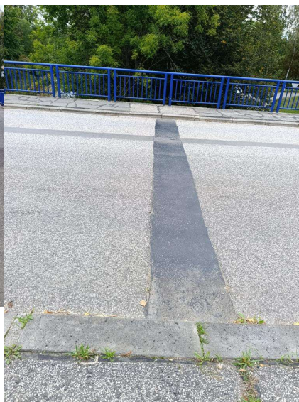
Stav krytu vozovky na mostě (2)
