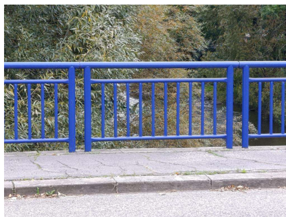
Právě zábradlí 43 ks
