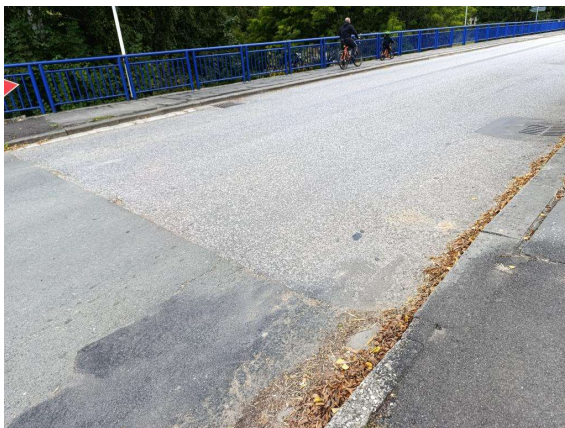
Stav krytu vozovky na mostě (5)
