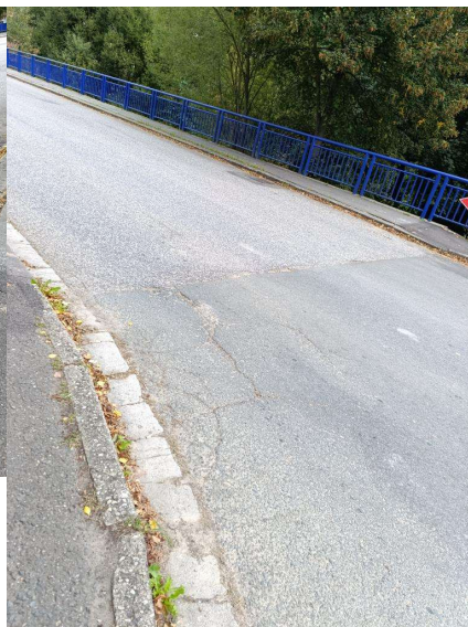
Stav krytu vozovky na mostě (6)
