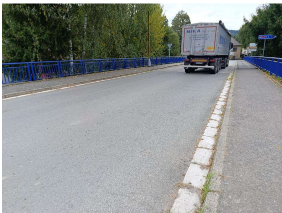
Stav krytu vozovky na mostě
