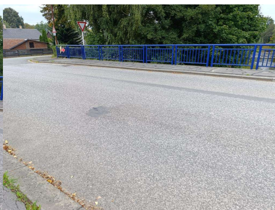
Stav krytu vozovky na mostě (4)
