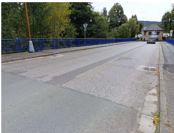
Stav krytu vozovky na mostě (1)
