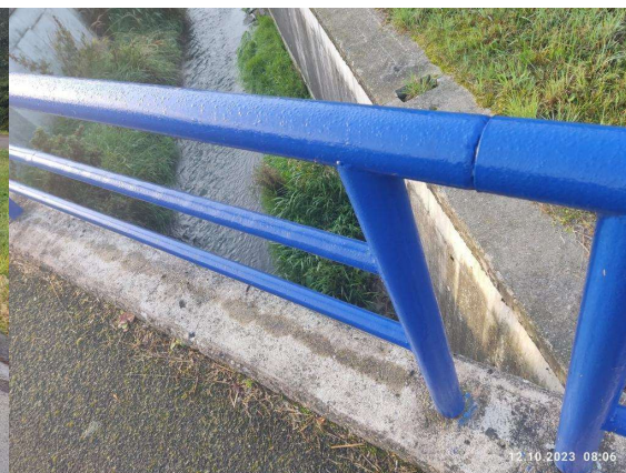
Stav nátěru pravého zábradlí
