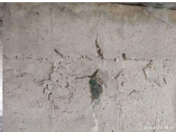
Lokální degradace povrchu betonu opěry OP1
