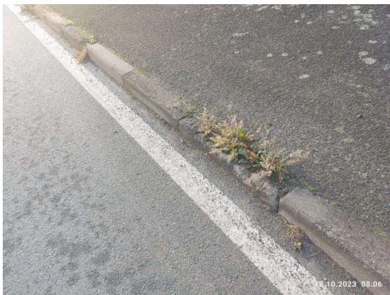
Degradace povrchu obrub u pravého chodníku
