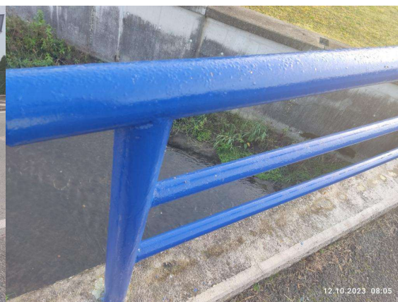
Stav nátěru levého zábradlí
