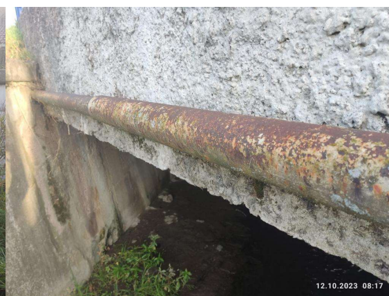
Koroze cizího zařízení vpravo
