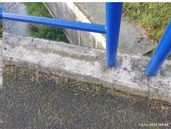
Příčné trhliny v pravé římse_
