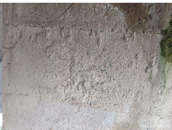
Lokální degradace povrchu betonu opěry OP2
