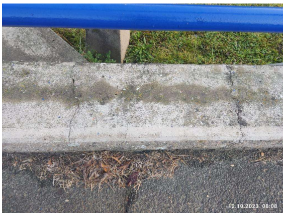
Příčné trhliny v pravé římse
