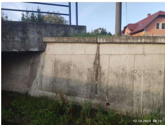
Levé křídlo na začátku mostu (K1)
