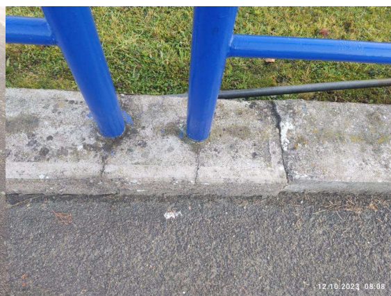
Příčné trhliny v levé římsě
