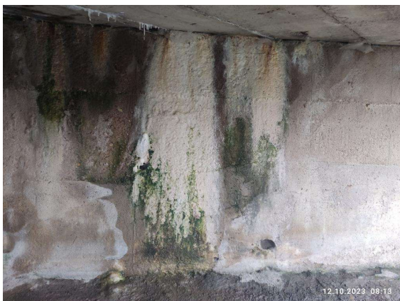
Vápné výluhy na opěře OP1
