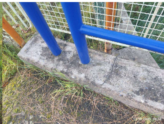
Příčné trhliny v pravé římse na konci mostu
