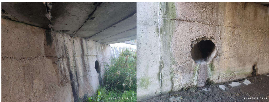
Vápenné výluhy na opěře OP2 vpravo
