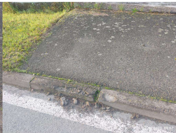
Degradace povrchu obrub u pravého chodníku_
