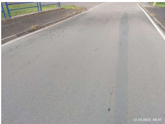
Stav krytu vozovky proti směru staničení
